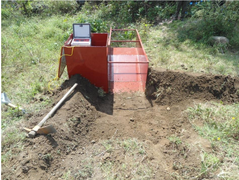
La estructura de aforo con medidor ultrasónico instalada.
