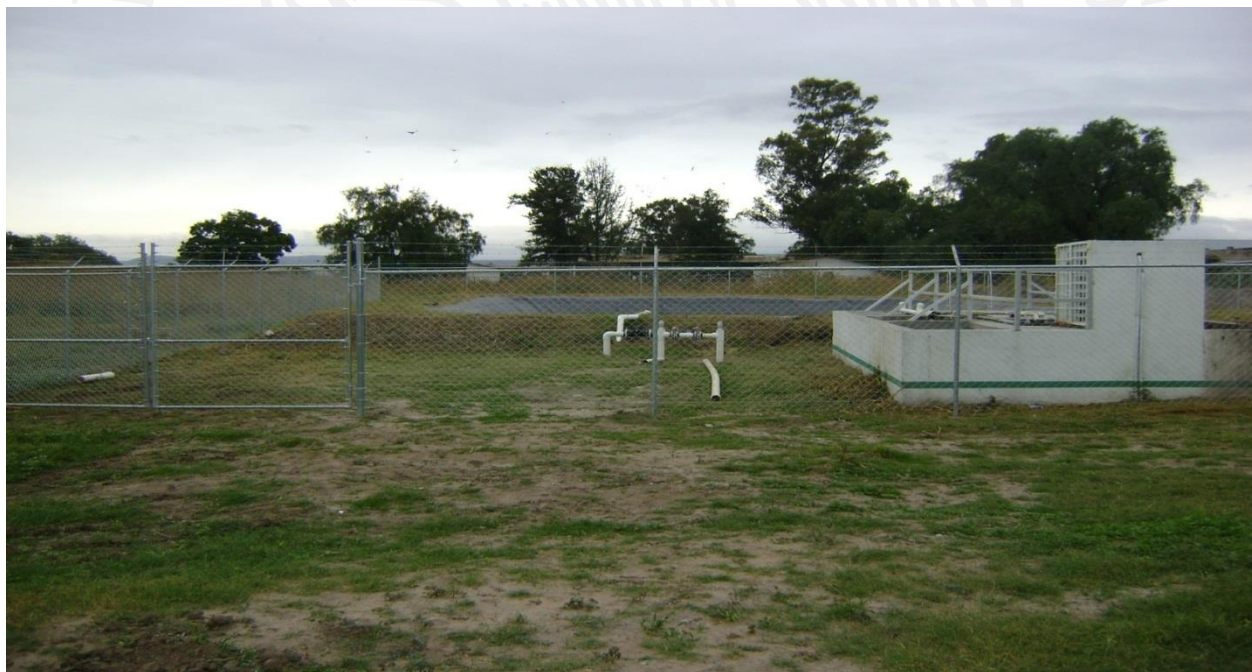
Ilustración 9. Planta tratadora y reservorio dentro del ITRoque.
