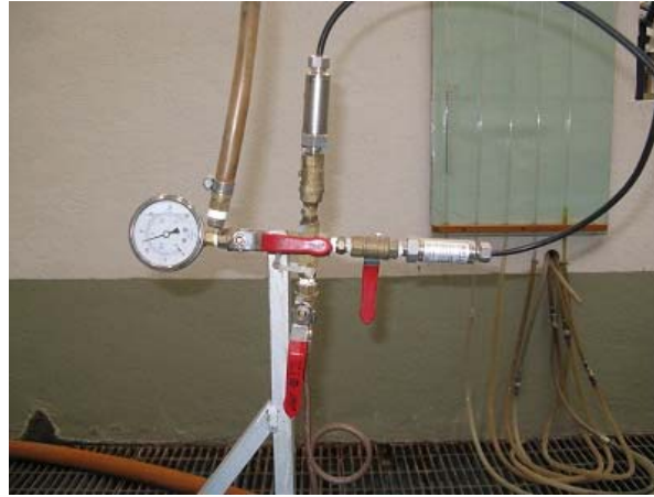
Presión en la descarga
