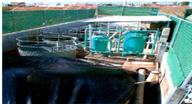
Figura 14 Planta Ecolo- System, instalada.
