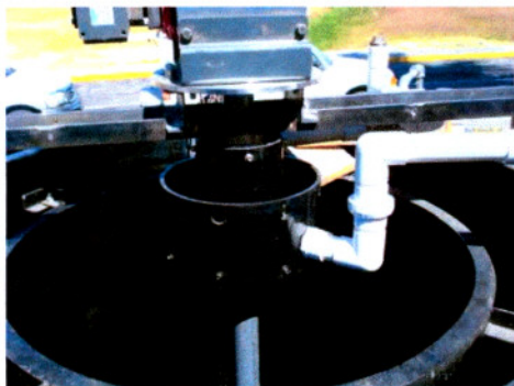
Figura 26 Ubicación de motorreductor, chumacera y flecha parte superior del biorreactor.
