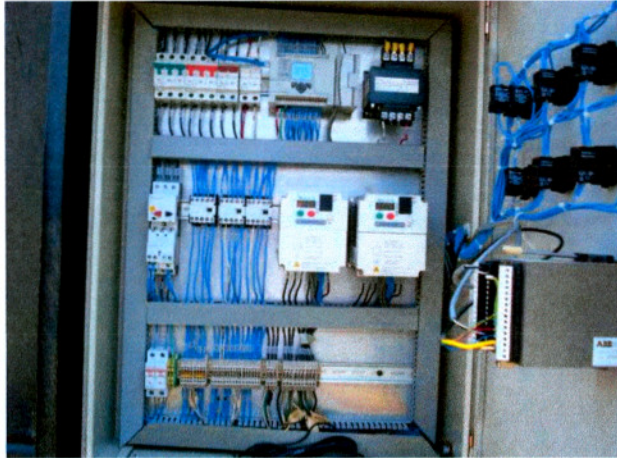
Figura 31 Tablero con los dispositivos de fuerza, protección, control y señalización de equipo del biorreactor vista interior.
