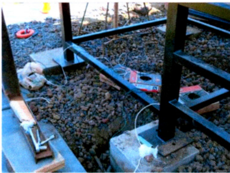
Figura 28 Instalación de sistema eléctrico de fuerza y control incluyendo sistema de tierras.
