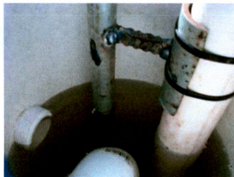
Figura 19 Descarga en salida final y prueba de ejector neumático para caudal de retorno.
