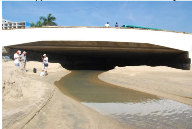
Fotografía 3. Medición de caudal y parámetros ambientales en la salida de la descarga del arroyo Aguas Blancas.
