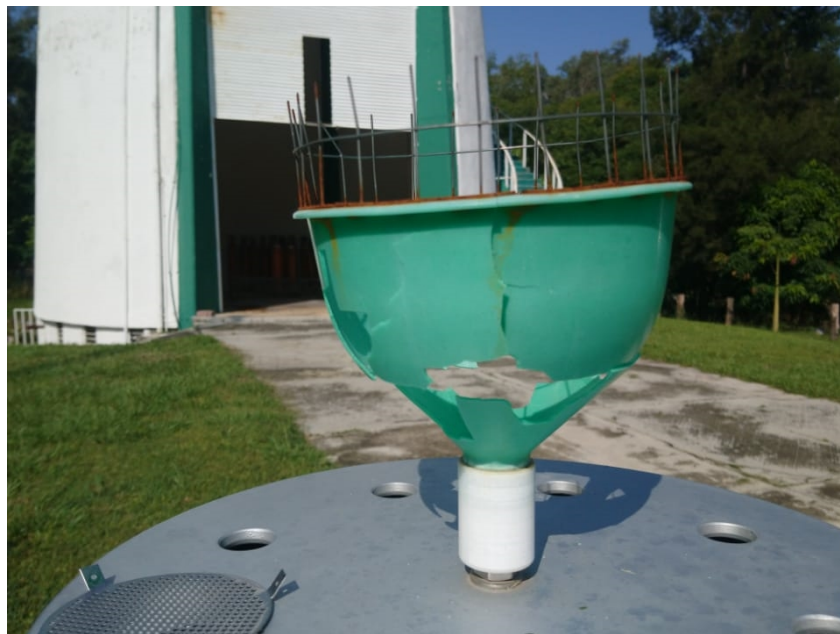
Figura 13 Embudo dañado debido a la exposición en climas cálidos estación Guadalajara
