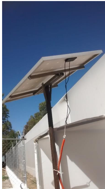
FIGURA 32. El panel solar que alimenta de energía el sistema de riego.
