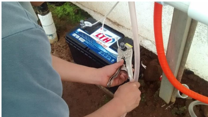
FIGURA 25. Conexión de batería en el invernadero con captación de lluvia.
