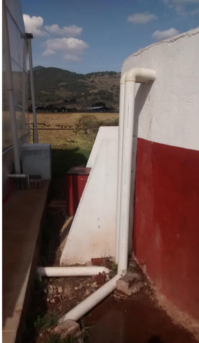
FIGURA 19. Tubos de entrada de agua al tanque-cisterna.
