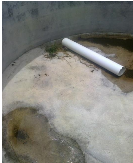
Figura 3. Interior del Tanque de descarga de fondo con el sifón destruido.
