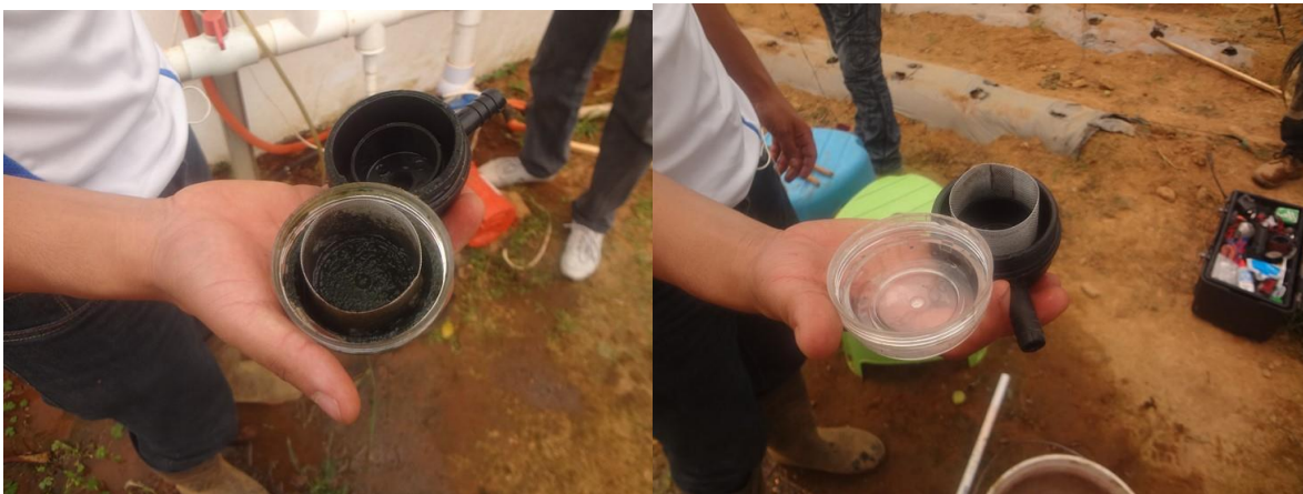
FIGURA 30. Filtro de la bomba sucio y después de la limpieza lista para funcionar adecuadamente.
