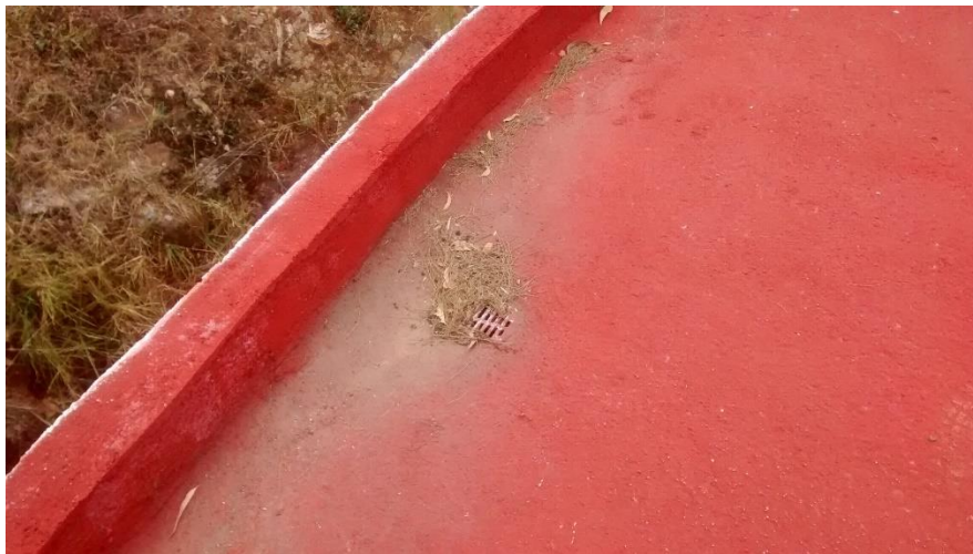
FIGURA 28. Acumulación de basura en entrada de agua al tanque.
