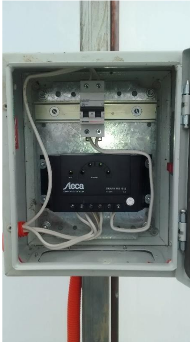
FIGURA 22. El controlador de carga en el invernadero.
