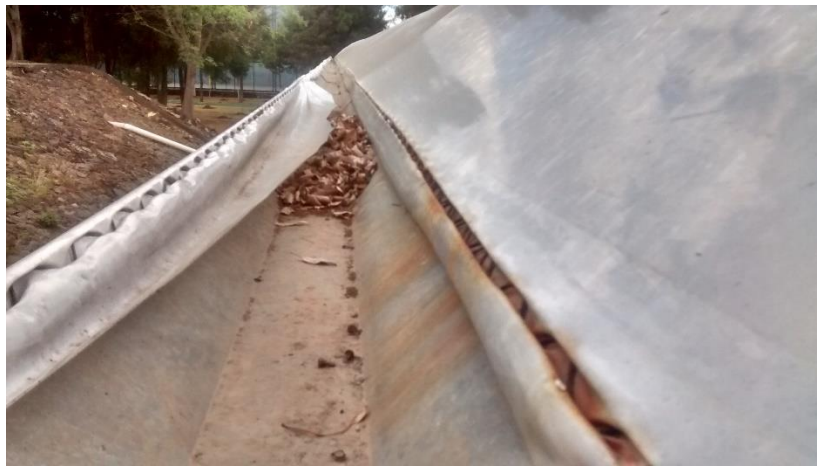
FIGURA 26. Hojarasca en la canaleta de conducción de agua del invernadero.
