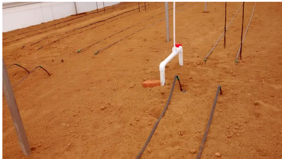
FIGURA 11. Válvula de control y cinta regante en la segunda sección de riego.
