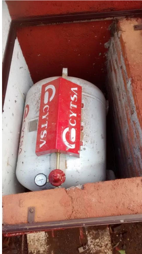
FIGURA 8. Tanque de gas para el sistema de calefacción en el invernadero.
