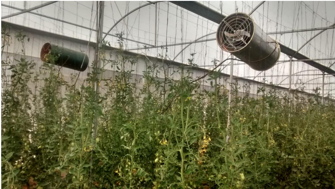
FIGURA 7. Generadores/distribuidores de aire caliente en el invernadero
