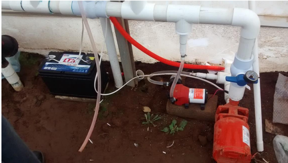
FIGURA 12. Bomba C.D. y Bomba C.A. para accionar sistema de riego.
