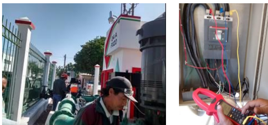
Figura 3. Medición de parámetros eléctricos en pozo 24-A
