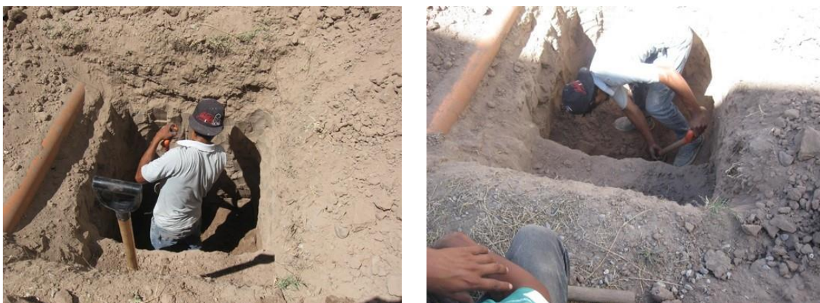
Figura 10. Pozo a cielo abierto (PCA) con profundidad de 2.10 metros para determinación de propiedades físicas y mecánicas del suelo en pozo 13-A
