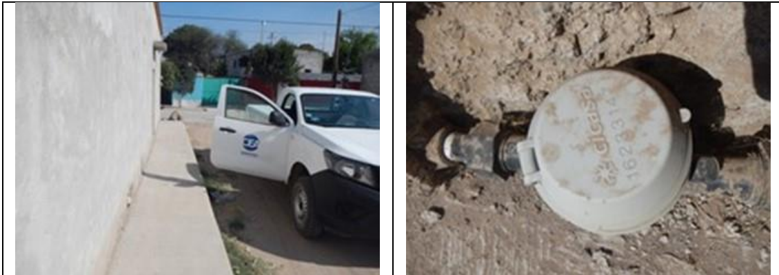
Figura 10. Medidor CICASA, MS Delaunet, 16233147, clase B, sin VAF. Cuadro de toma y detalle de medidor con número de serie. Comunidad El sauz alto, municipio de Pedro Escobedo. Lectura del medidor: 27.72 m 3 . Atendió el titular del contrato. Comentó que tiene rentada la casa. Se encontró que debe corregirse el modelo (es MS Delaunet, no MMD-15-NG) en el catálogo de medidores del sistema informático.
