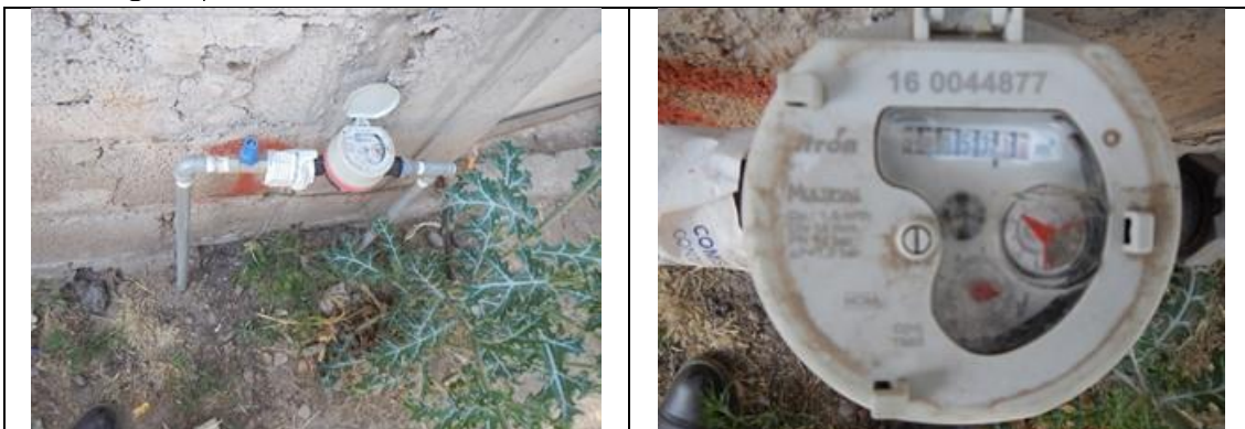
Figura 6. Medidor Itrón, Multimag 160044877, clase C, con VAF. Cuadro de toma y detalle de medidor con número de serie. Colonia Chalmita la "D", municipio de Pedro Escobedo. Lectura del medidor: 53.19 m 3 .
