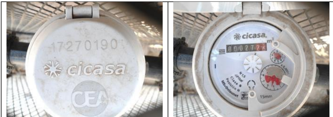
Figura 8. Medidor CICASA, MS Delaunet 17270190, clase B, con VAF. Detalles de medidor con número de serie. Comunidad Dolores de Ajuchitlancito, municipio de Pedro Escobedo. Lectura del medidor: 27.25 m3. Se encontró que debe corregirse el modelo (es MS-Delaunet, no MMD-15-LR) en el padrón de usuarios. Atendió esposa del usuario titular.
