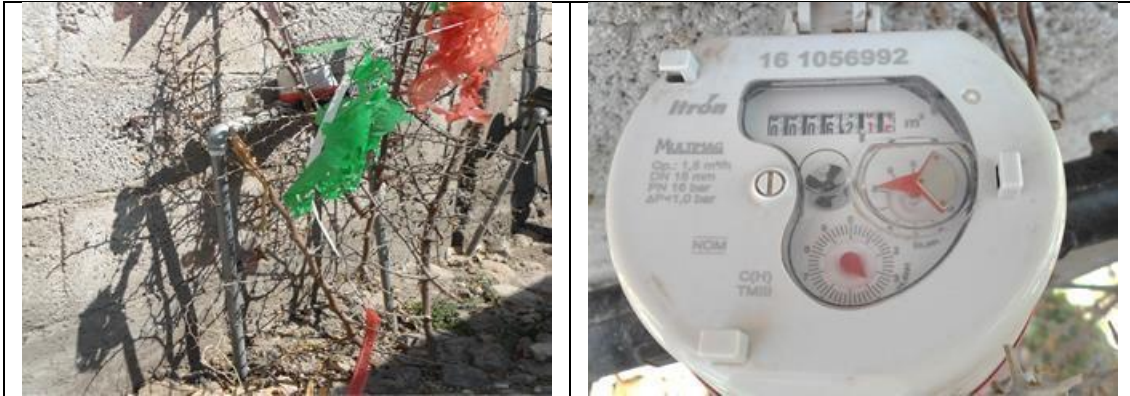
Figura 7. Medidor Itrón, Multimag 161056992, clase C, con VAF. Cuadro de toma y detalle de medidor con número de serie. Comunidad Dolores de Ajuchitlancito, municipio de Pedro Escobedo. Lectura del medidor: 62.14 m3. Se encontró que debe corregirse la marca (es Itrón, no Itrón-Actaris) en el padrón de usuarios. Atendió esposa del usuario titular.
