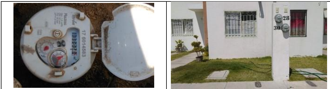
Figura 29. Medidor Itrón, Multimag 176014583, clase C, sin VAF. Detalle de medidor con número de serie. Fracc. Las Canteras, municipio de Pedro Escobedo. Lectura del medidor: 55.149 m 3 . Se encontró que debe corregirse la marca (es Itrón, no Itrón-Actaris) en el padrón de usuarios. El medidor está instalado en la banqueta. No se encontró a ninguna persona en el domicilio.
