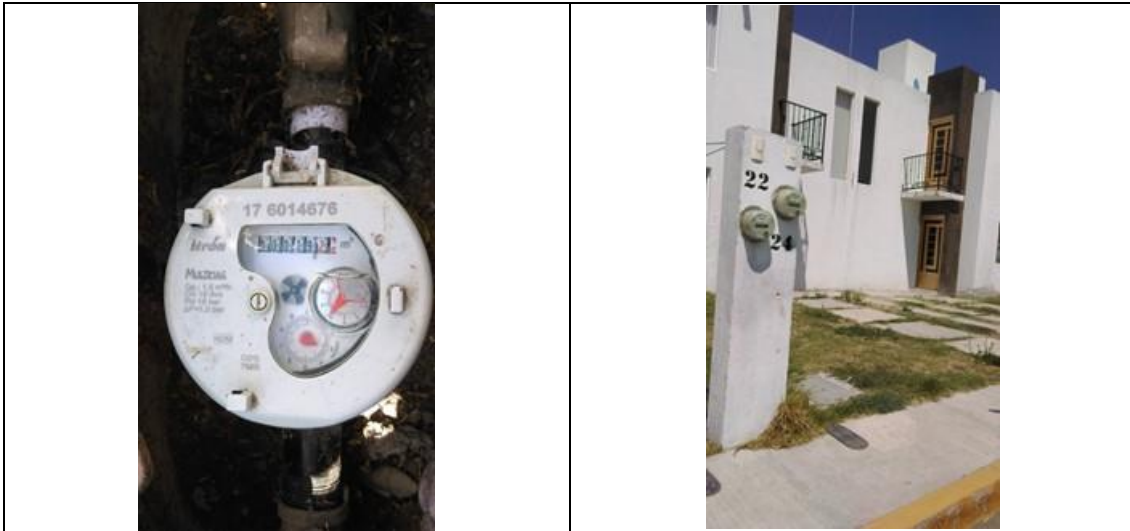
Figura 28. Medidor Itrón, Multimag 176014676, clase C, sin VAF. Detalle de medidor con número de serie. Fracc. Las Canteras, municipio de Pedro Escobedo. Lectura del medidor: 19.246 m 3 . Se encontró que debe corregirse la marca (es Itrón, no Itrón-Actaris) en el padrón de usuarios. El medidor no tiene su tapa y está instalado en la banqueta. No se encontró a ninguna persona en el domicilio.
