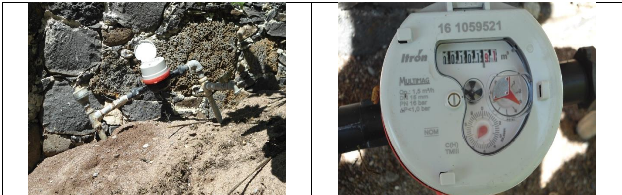
Figura 12. Medidor 161059521, clase C. Toma y detalle de medidor con número de serie. Sin VAF. Carr. Federal Jalpan-Río Verde S/N, localidad Mesas de Agua Fría. Lectura del medidor: 101.97 m 3 . El número de medidor corresponde con el número proporcionado por la CEA, sin embargo la marca, modelo y características (clase) del medidor no corresponden a las registradas en el padrón de usuarios.
