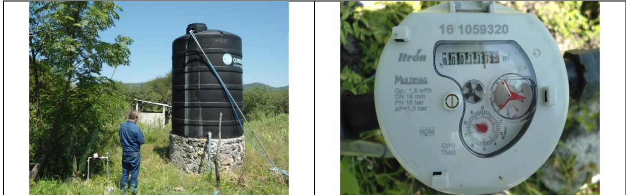
Figura 31. Medidor 161059320, clase C. Predio con toma y detalle de medidor con número de serie. Con VAF. Carretera a Río Carrizal S/N, localidad La Cantera. Lectura del medidor: 11.75 m 3 . El número de medidor corresponde con el número proporcionado por la CEA, sin embargo la marca, modelo y características (clase) del medidor no corresponden a las registradas en el padrón de usuarios. El depósito que se observa en la fotografía no es del usuario, es de la CEA para abastecimiento de la zona.
