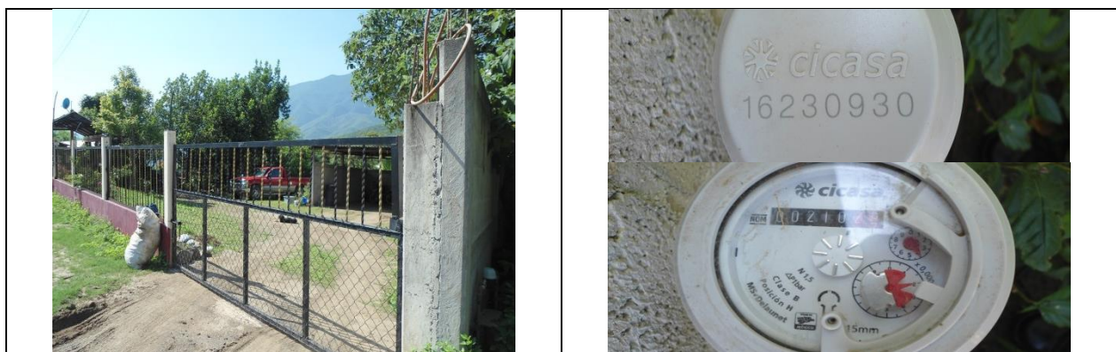
Figura 10. Medidor 16230930, clase B. Predio con toma y detalles de medidor con número de serie. Con VAF. Carr. Federal Jalpan-Río Verde S/N, localidad Mesas de Agua Fría. Lectura del medidor: 210.26 m 3 . Se encontró que el modelo del medidor no corresponde al registrado en el padrón de usuarios de la CEA.
