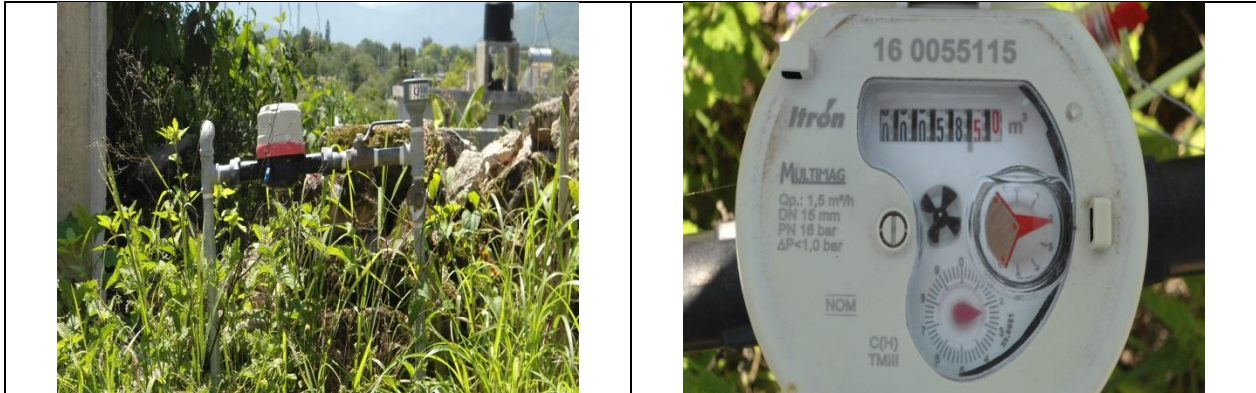
Figura 22. Medidor 160055115, clase C. Toma y detalle de medidor con número de serie. Con VAF. Calle Francisco Márquez S/N, Barrio La Loma. Lectura del medidor: 58.50 m 3 . Se encontró que el modelo del medidor no corresponde al registrado en el padrón de usuarios de la CEA.
