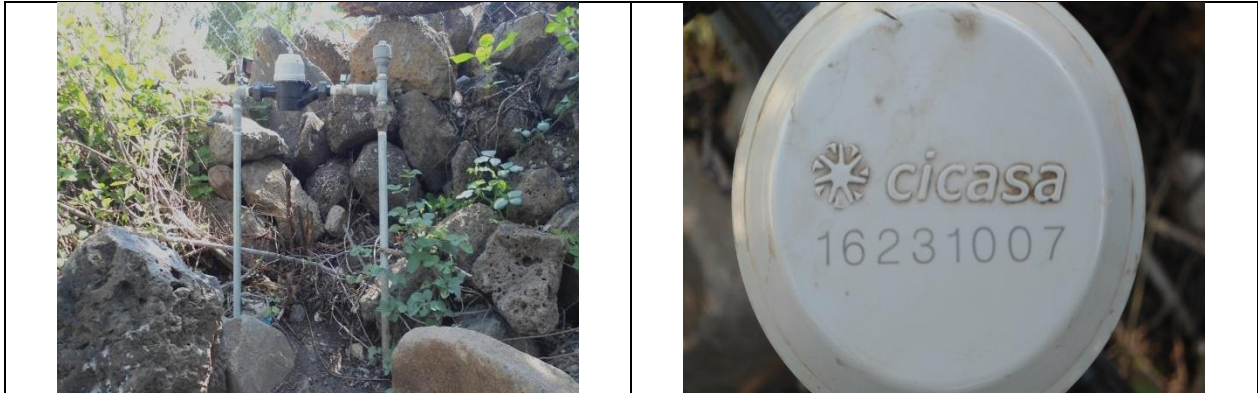
Figura 11. Medidor 16231007, clase B. Toma y detalle de medidor con número de serie. Con VAF. Camino Antiguo Jalpan-Río Verde S/N, localidad Mesas de Agua Fría. Lectura del medidor: 55.55 m 3 . Se encontró que el modelo del medidor no corresponde al registrado en el padrón de usuarios de la CEA.
