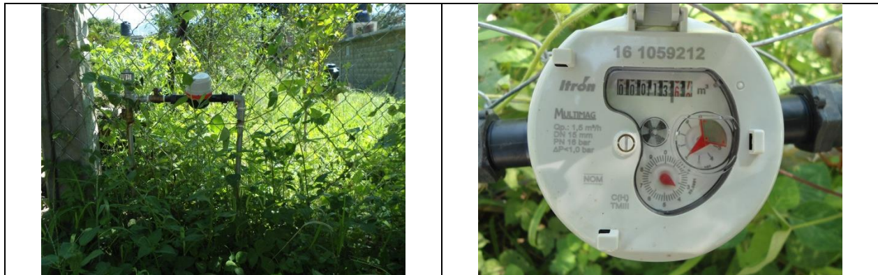
Figura 9. Medidor 161059212, clase C. Predio con toma y detalle de medidor con número de serie. Con VAF. Carretera a la Florida S/N, localidad Mesa de Palo Blanco. Lectura del medidor: 13.67 m 3 . El número de medidor corresponde con el número proporcionado por la CEA, sin embargo la marca, modelo y características (clase) del medidor no corresponden a las registradas en el padrón de usuarios.
