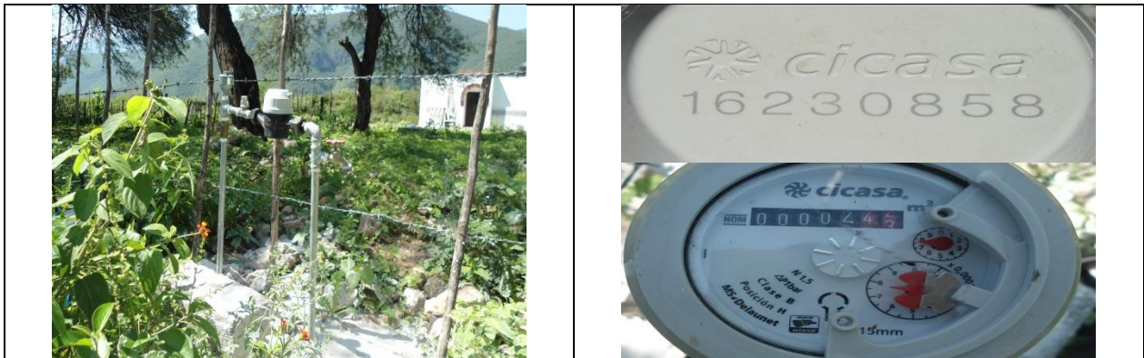
Figura 15. Medidor 16230858, clase B. Predio con toma y detalles de medidor con número de serie. Con VAF. Camino Antiguo Jalpan-Río Verde S/N, localidad Mesas de Agua Fría. Lectura del medidor: 2.42 m 3 . Se encontró que el modelo del medidor no corresponde al registrado en el padrón de usuarios de la CEA.
