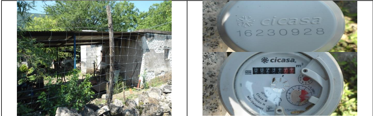
Figura 14. Medidor 16230928, clase B. Predio y detalles de medidor con número de serie. Con VAF. Camino Antiguo Jalpan-Río Verde S/N, localidad Mesas de Agua Fría. Lectura del medidor: 231.71 m 3 . Se encontró que el modelo del medidor no corresponde al registrado en el padrón de usuarios de la CEA.
