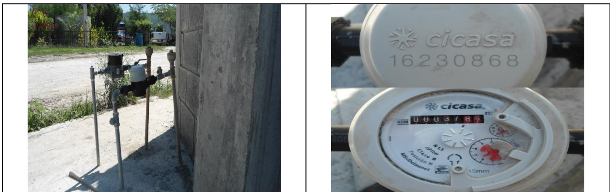
Figura 21. Medidor 16230868, clase B. Toma y detalles de medidor con número de serie. Con VAF. Calle Francisco Javier Mina S/N, Barrio La Loma. Lectura del medidor: 37.86 m 3 . Se encontró que el modelo del medidor no corresponde al registrado en el padrón de usuarios de la CEA.
