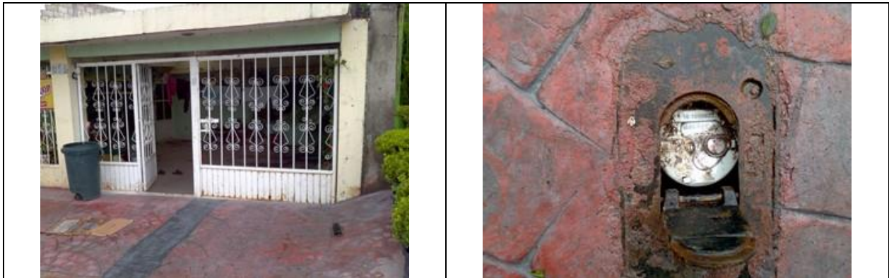
Figura 5. Medidor 161059621, clase C. Predio con toma y detalle de medidor con número de serie. No se aprecia si tiene VAF. Heroico Colegio Militar no. 954, col. Centro. Usuario manifestó que tiene servicio. Lectura del medidor: 25.31 m 3 .
