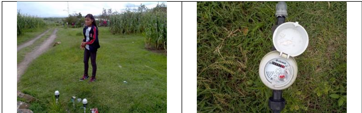
Figura 16. Medidor 16114477, clase B. Predio con toma y detalle de carátula de medidor. Sin VAF. Dom. Conocido, localidad Yosphi. Sustitución por medidor roto al pasarle un carro encima (lecturista). Toma alejada del predio. Recibo con comisionista. Lectura del medidor: 96.2 m 3 .
