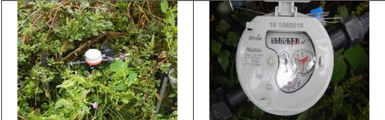
Figura 28. Medidor 161060018, clase C. Toma y detalle de medidor con número de serie. Sin VAF. Domicilio conocido, localidad Los Toriles. El personal de la CEA comentó que este predio ya se ubica administrativamente en el Estado de México, en el municipio de Acambay. Toma alejada de la vivienda a la cual abastece. Lectura del medidor: 26.98 m 3 .
