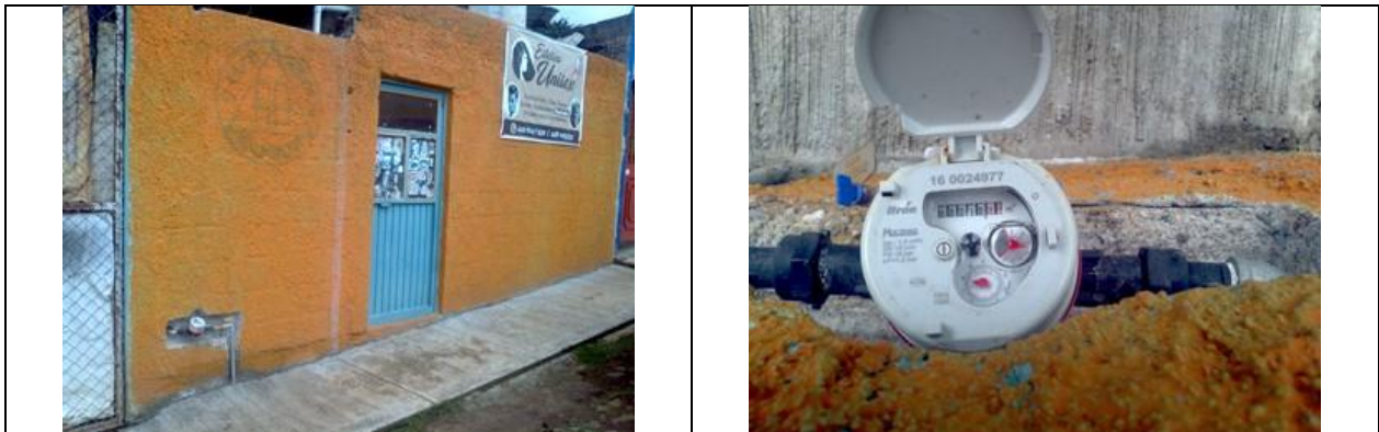
Figura 18. Medidor 160024977, clase C. Predio con toma y detalle de medidor con número de serie. Sin VAF. Calle 15 de mayo s/n, col. El Vicario. Toma nueva. El usuario comentó que el predio era baldío, ya que era centro de rehabilitación, y que acarrearán en tambos. De momento no habitada. Lectura del medidor: 10.89 m 3 .
