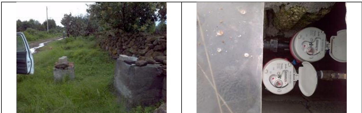
Figura 8. Medidor 160025152, clase C. Predio con toma y detalle de medidor con número de serie. Sin VAF. Comunidad El Rayo. Toma nueva. Atendió Josefina Álvarez, mamá adoptiva del titular del contrato. Comentó que el recibo les llega en una tienda, y que el servicio es continuo desde que se entregó a la CEA. El lectorista indicó que los medidores se paran a veces por las arenillas. Lectura del medidor: 46.19 m 3 .
