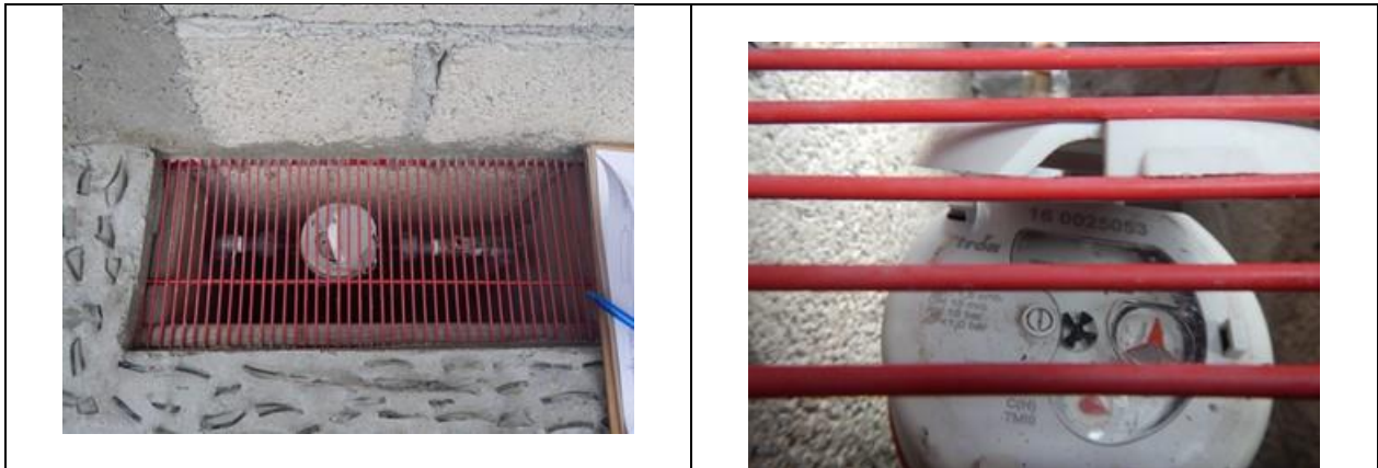
Figura 20. Medidor 160025053, clase C. Toma y detalle de medidor con número de serie. Sin VAF. Domicilio conocido, localidad San Miguel Tlaxcaltepec. No se encontró en el domicilio al usuario. La toma y medidor están encerrados por muros y una rejilla que dificulta su acceso, incluso la toma de lectura. Lectura del medidor: 20.48 m 3 .
