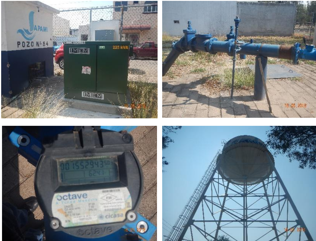
Ilustración 2. Infraestructura en el pozo No. 84 – Pozo, tanque y medidor de gasto.
