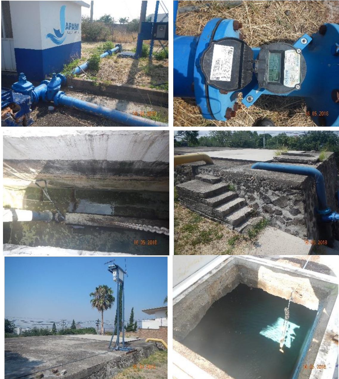
Ilustración 3. Infraestructura en el pozo No. 50 – Pozo, medidor, cisterna - rebombeo y tanque.
