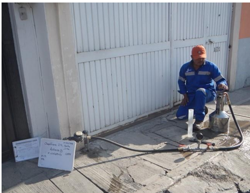
Ilustración 11. Elementos del equipo para realizar las pruebas volumétricas de los medidores
