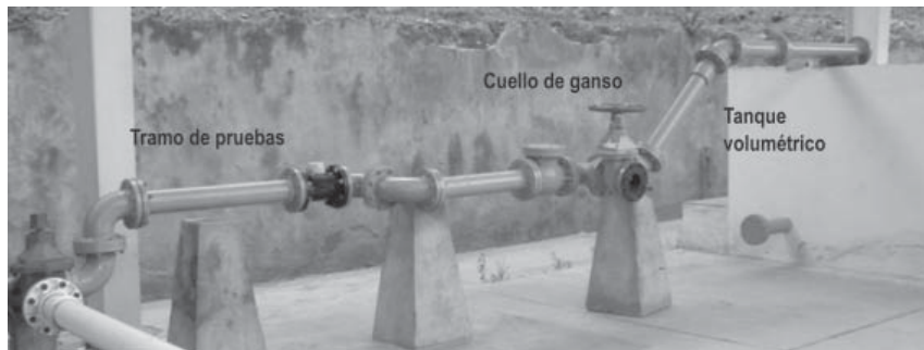
Figura 3. Vista general del tramo de pruebas, cuello de ganso y tanque volumétrico.
