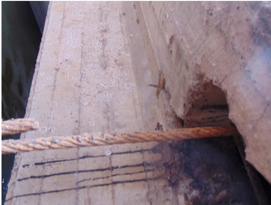
Figura 2.17 Acero de refuerzo expuesto.
