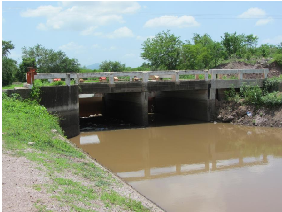
Figura 2.3 Fallo de muros de contención pertenecientes a la represa.
