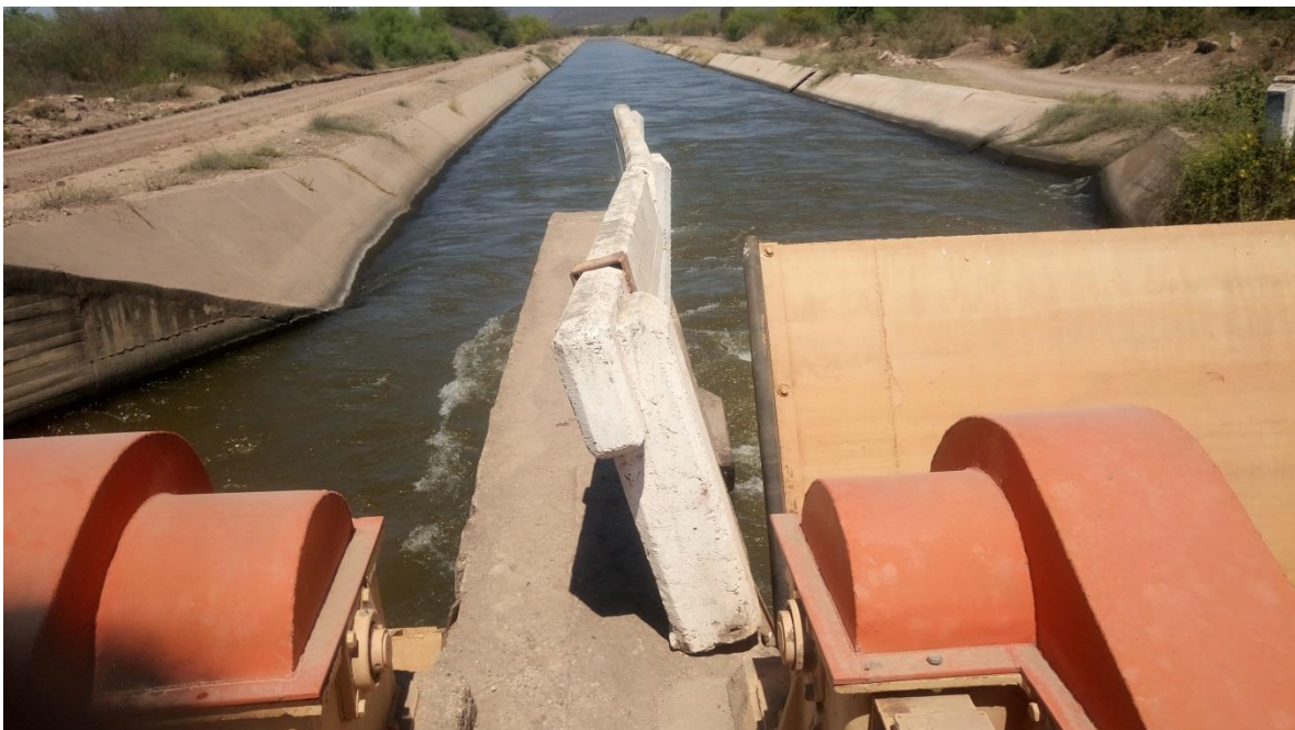
Figura 2.10 Estructura de protección colapsada.
