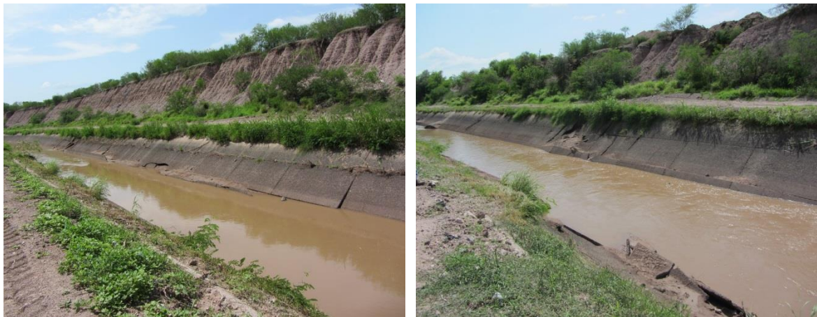
Figura 4.5 Losas colapsadas en el talud del canal.
