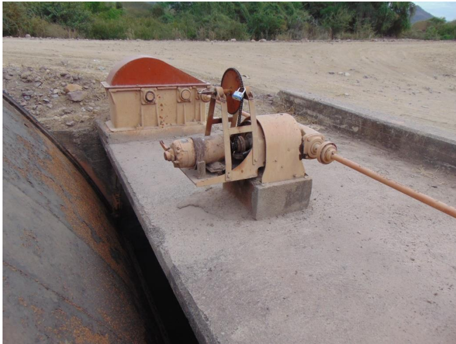
Figura 2.19 Maquinaria en desuso y obsoleta.
