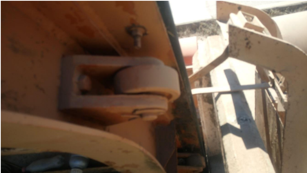
Figura 2.9 Falta de mantenimiento generalizado a las compuertas radiales.
