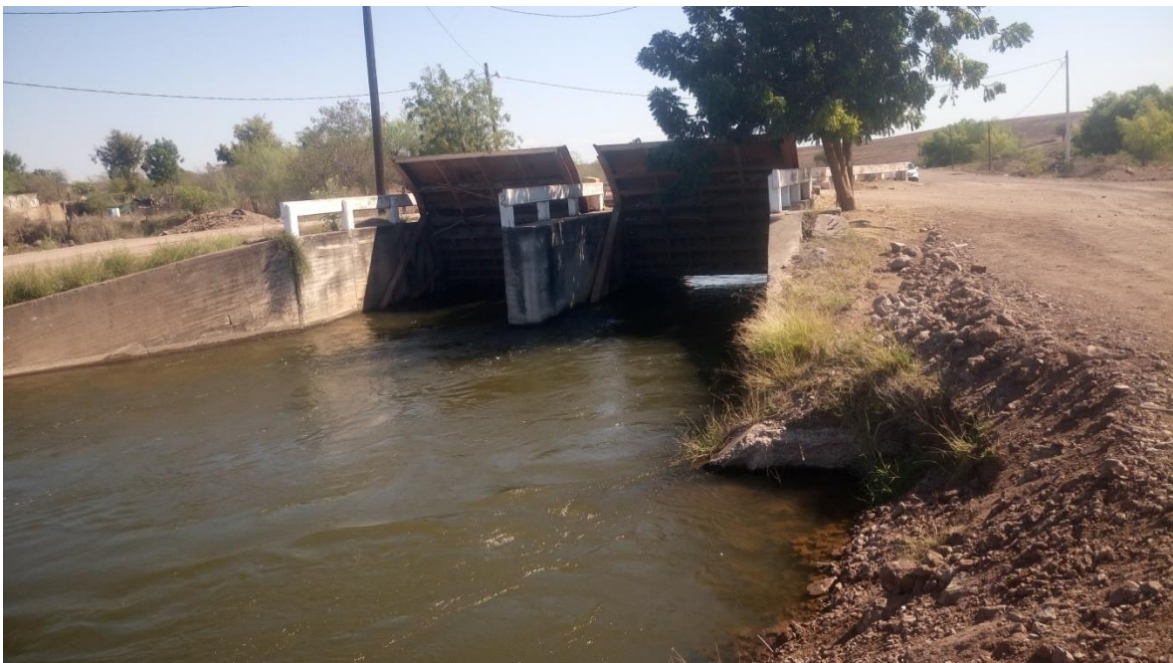
Figura 2.6 Árboles ejerciendo presión sobre muros en transición de salida.
