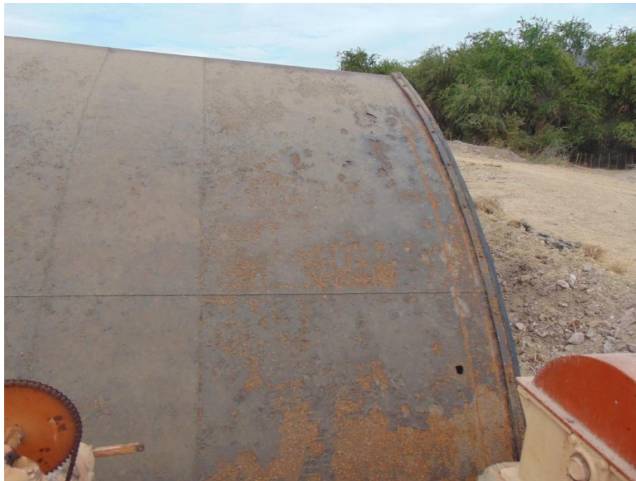
Figura 2.16 Fisuras y oxidación en compuerta radial.
