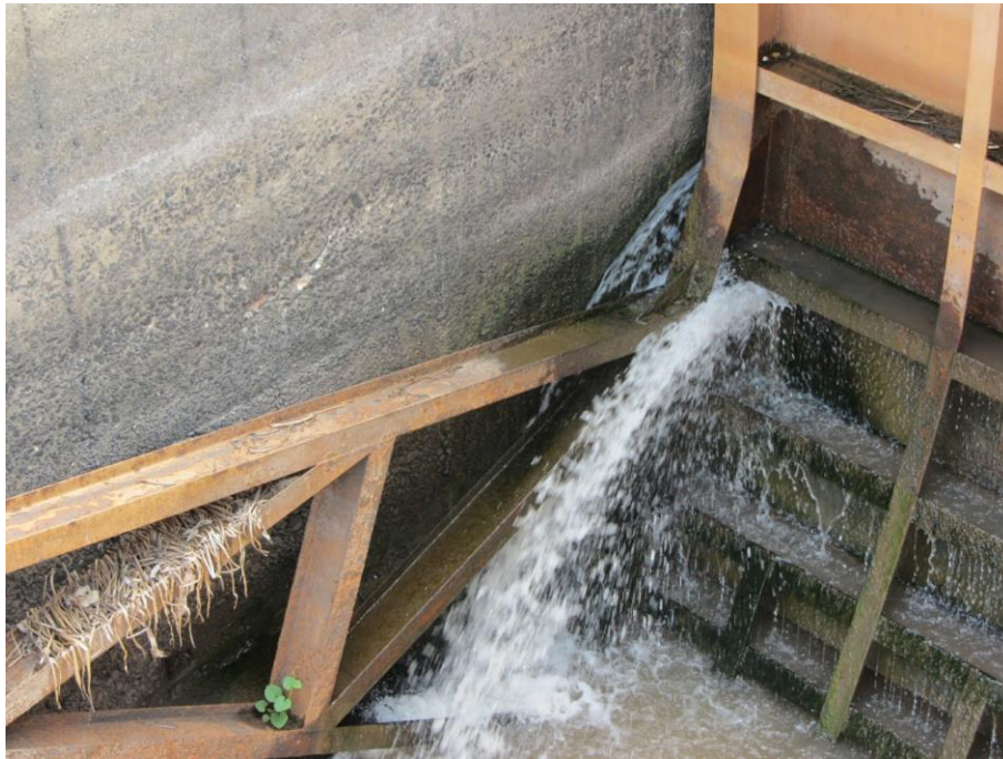
Figura 2.1 Compuerta radial con fisuras en placa de retención.
