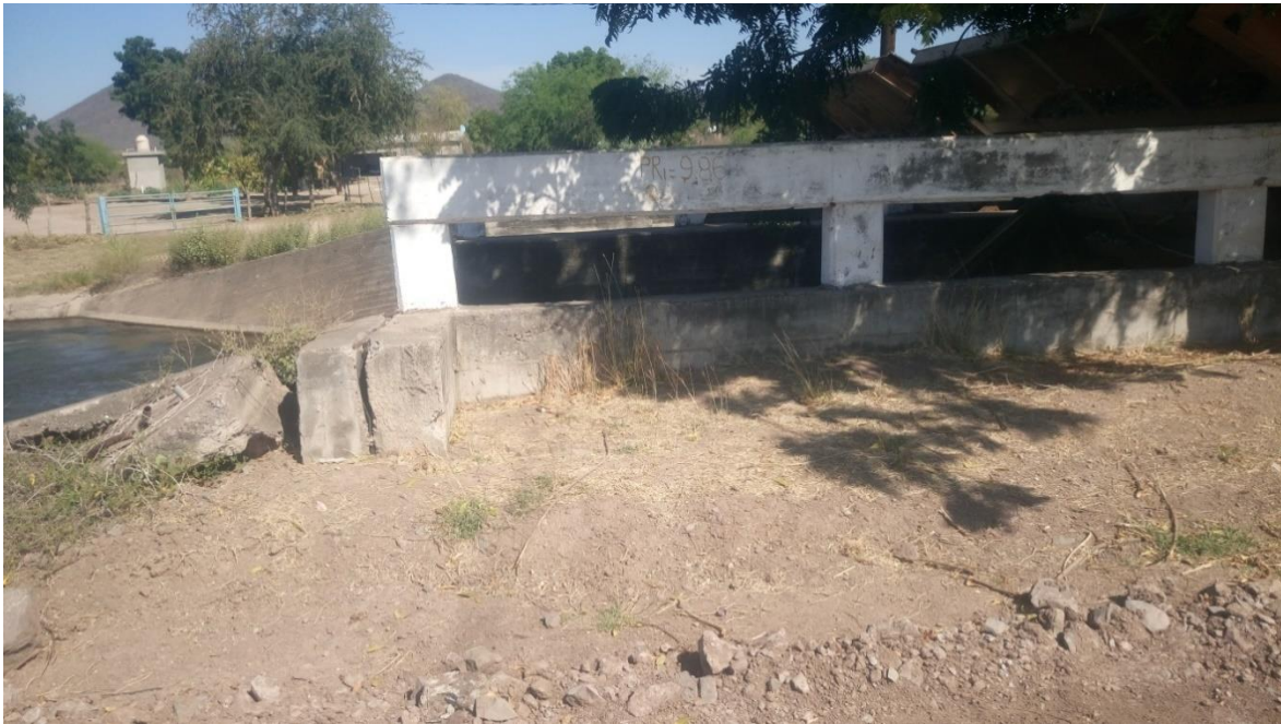
Figura 2.5 Desprendimiento de la losa de transición de salida y parapeto desplomado.
