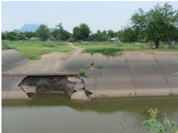
Figura 3.A.4 Entrada de agua en el km 20+330 del CPH, lugar donde se forma un pequeño dique en los alrededores del poblado “El Mojolo”, municipio de Culiacán, Sinaloa.
