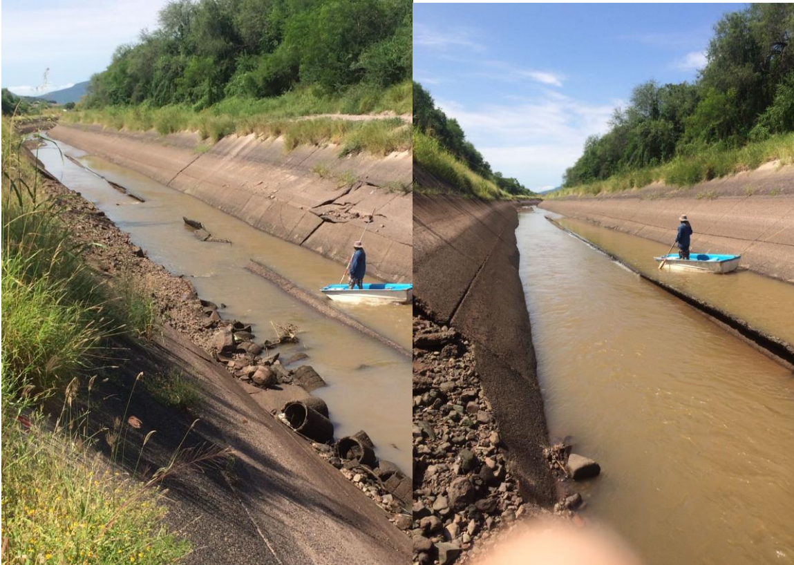
Figura 4.6 Losas dañadas en la plantillas y tramo en mal estado de conservación en el tramo del km 82+840 al km 84+445.
