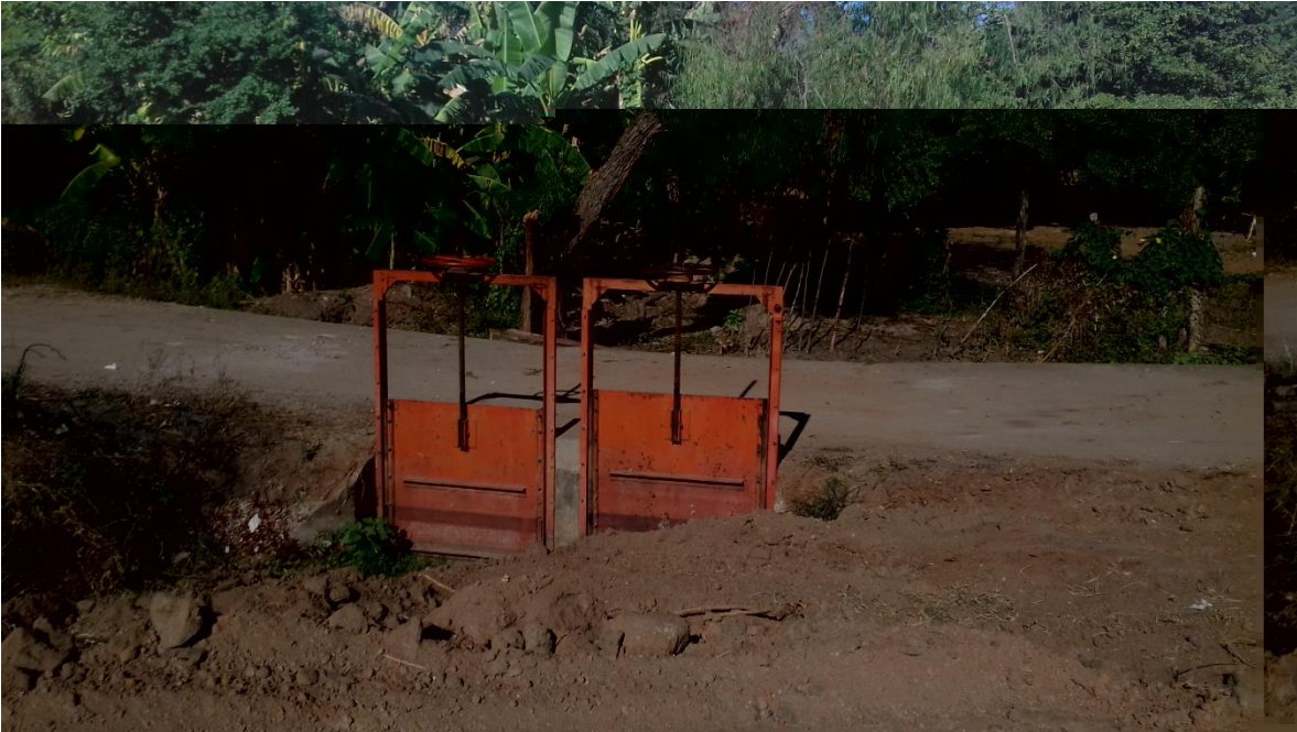
Figura 3.A.8 Entrada de agua cercana con escurrimientos pluviales del poblado.
