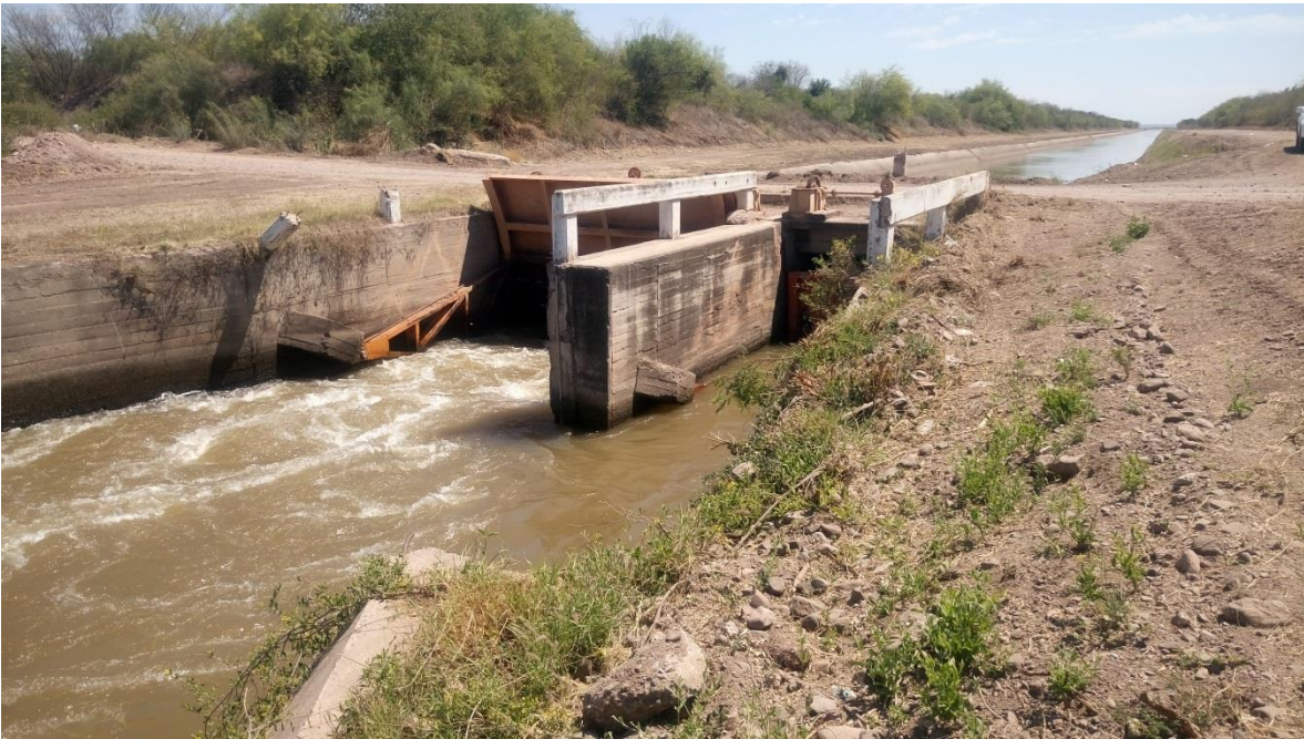
Figura 2.11 Falla en muros cubiertas por el agua.
