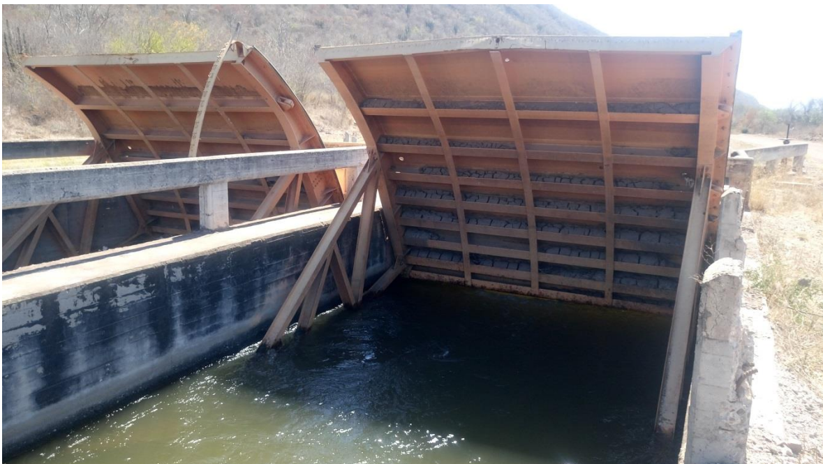
Figura 2.8 Protecciones de concreto reforzado destruido y expuesto al intemperismo.
