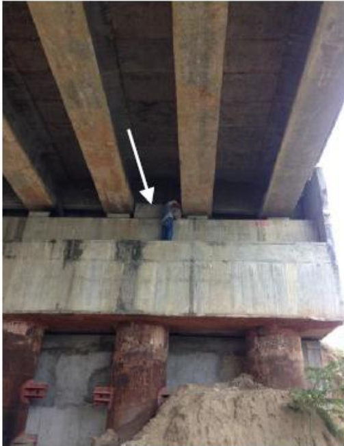
Figura 8.14. Ubicación del extensómetro en el cabezal de margen derecha del puente La Pigua III.
