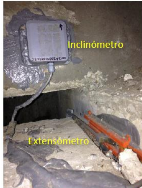
Figura 8.15. Aspecto del extensómetro e inclinómetro instalados en el cabezal de margen derecha de La Pigua III.
