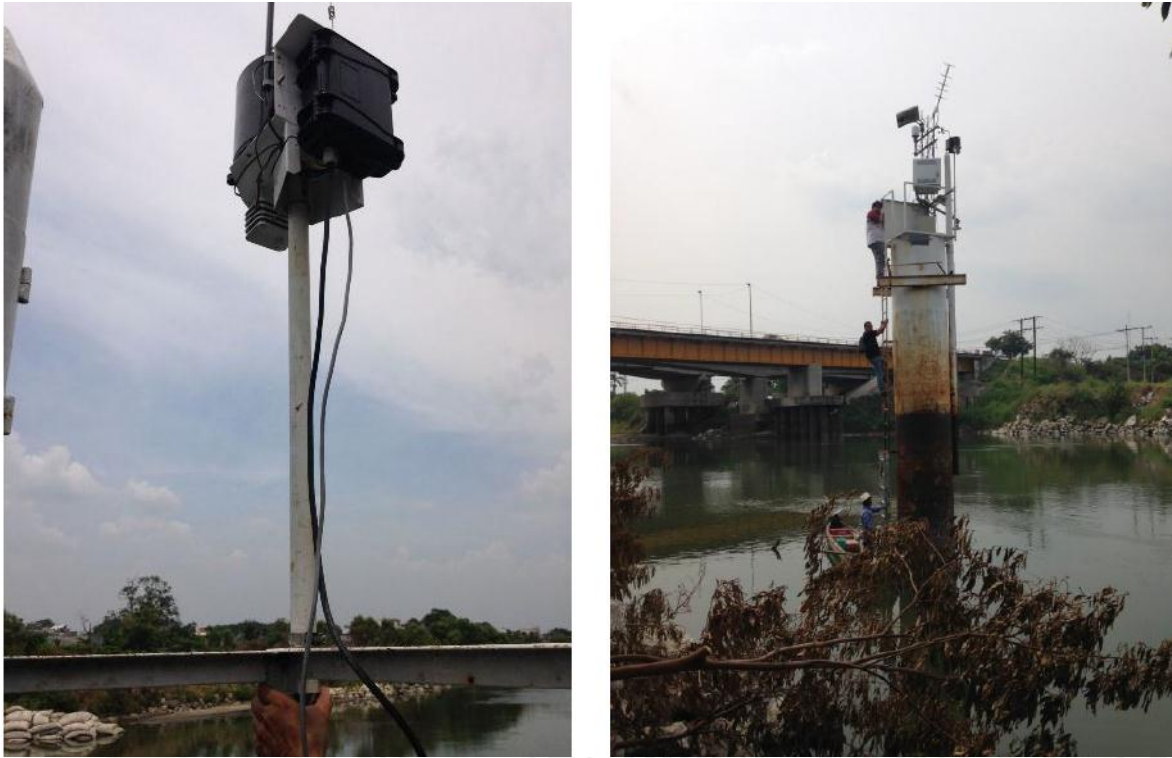
Figura 8.18. Sitio donde se efectuó la instalación del sensor de variación de nivel del cauce Carrizal y variables climáticas.
