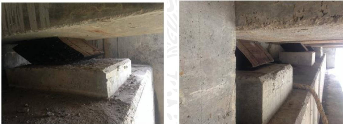
Figura 8.2. Deformaciones en neoprenos del cabezal de margen derecha.
