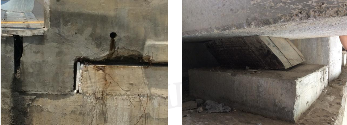
Figura 8.1. Desplazamientos y grietas en neoprenos y estructuras de concreto.
