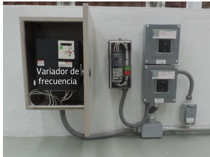
Figura III-10 Controles de las bombas.
