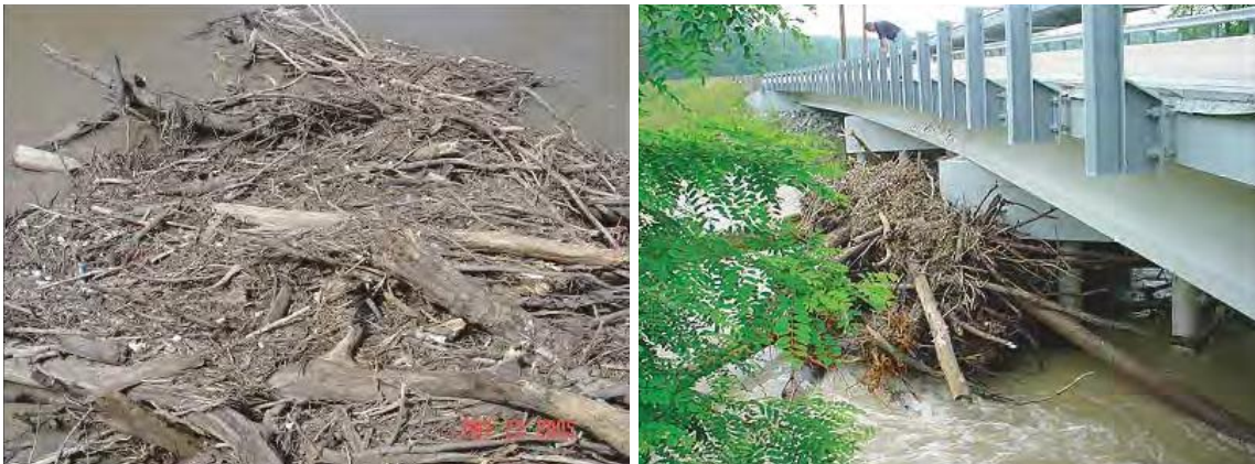
Figura II-1 Fotografías de obstrucciones de material leñoso en pilas.
