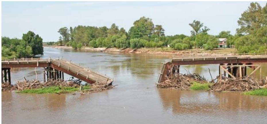
Figura I-11 Puente colapsado (Gualeguay).
