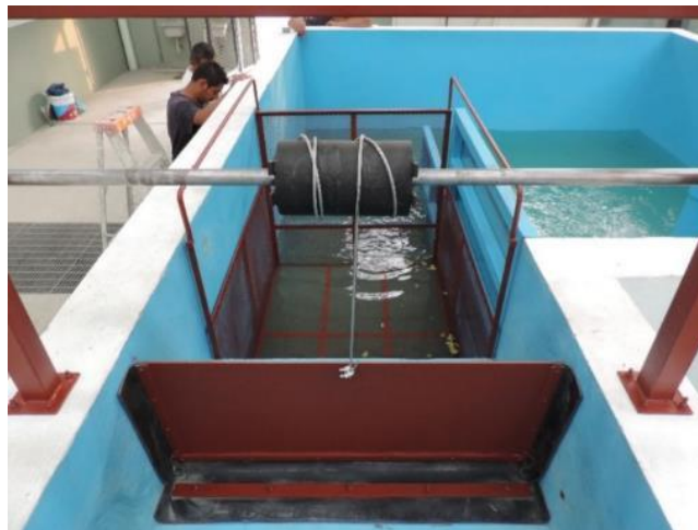
Figura III-7 Compuerta para controlar niveles y canasta para retención de sólidos.
