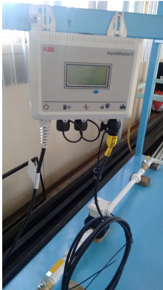
Ilustración 43 Registrador del medidor electromagnético ABB.
