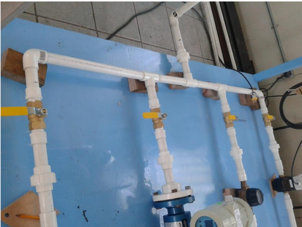
Ilustración 37. Válvulas y tuerca unión antes de cada medidor
