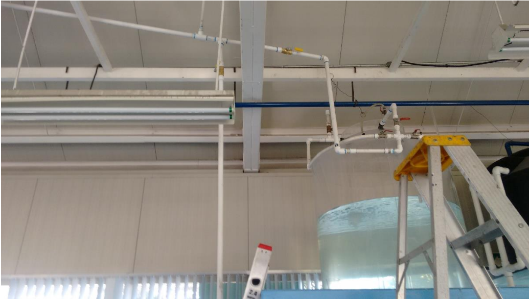
Ilustración 36. Válvulas de paso para tinaco en acrílico y los medidores.
