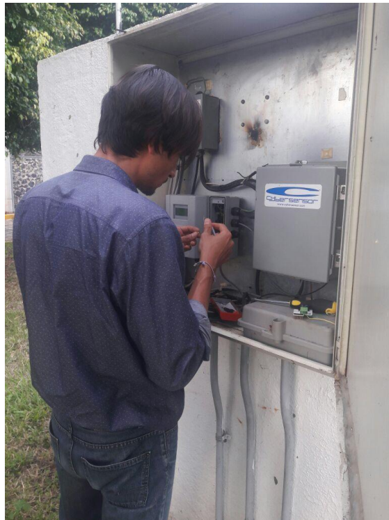
Ilustración 16 Conexión del Arduino YUN con el tablero del medidor Badger Meter en el Pozo IMTA
