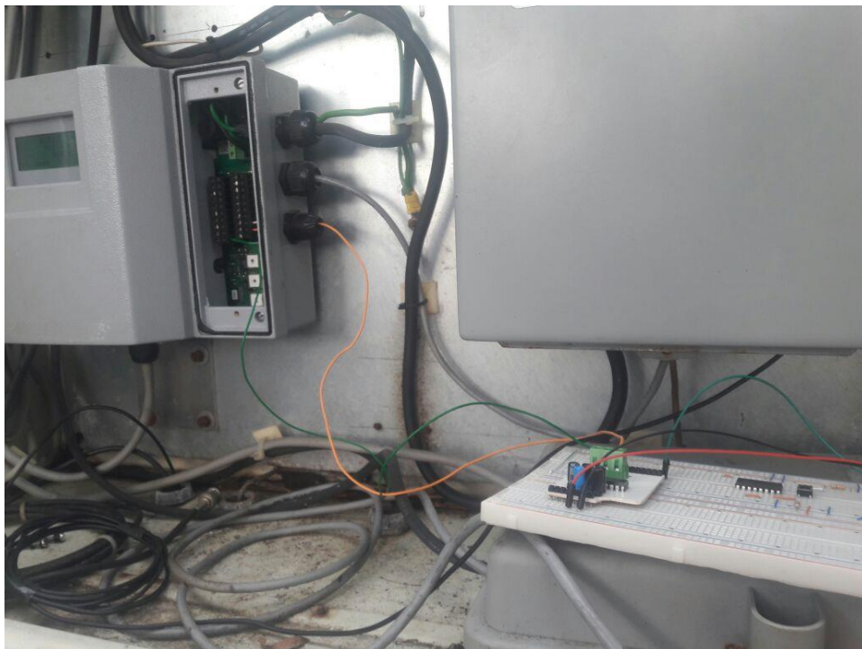
Ilustración 18 Conexión del Arduino YUN con el tablero del medidor Badger Meter en el Pozo IMTA, sobre un protoboard.
