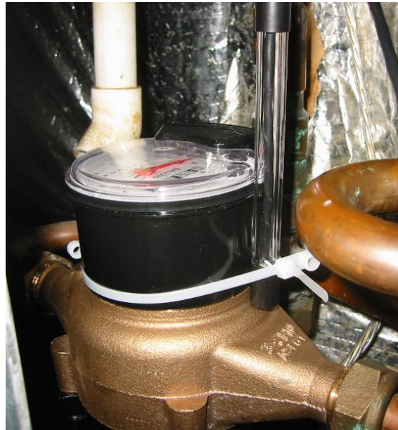
Ilustración 9 Medidor de agua con sensor de efecto Hall anexo.
