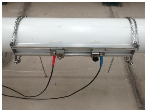
Ilustración 2.15. Medidor ultrasónico de tiempo en tránsito: transductores instalados.
