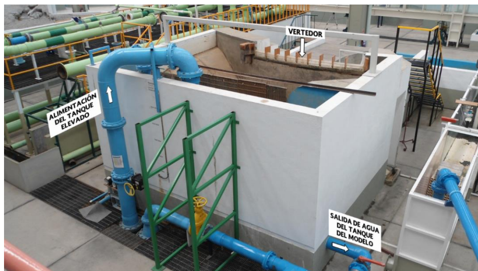
Ilustración 2.8. Vista del tanque de alimentación del modelo del vertedor de la presa Zapotillo.
