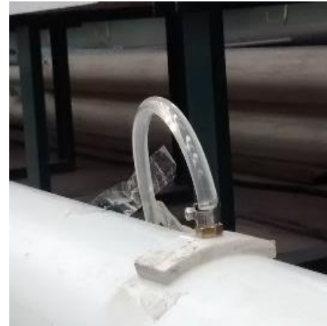
Ilustración 2.18. Tubos piezométricos: conexión a tubería.
