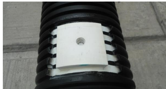
Ilustración 2.23. Trabajos realizados en la tubería de polietileno para instalar la toma de carga de presión: colocación de insertos de PVC.
