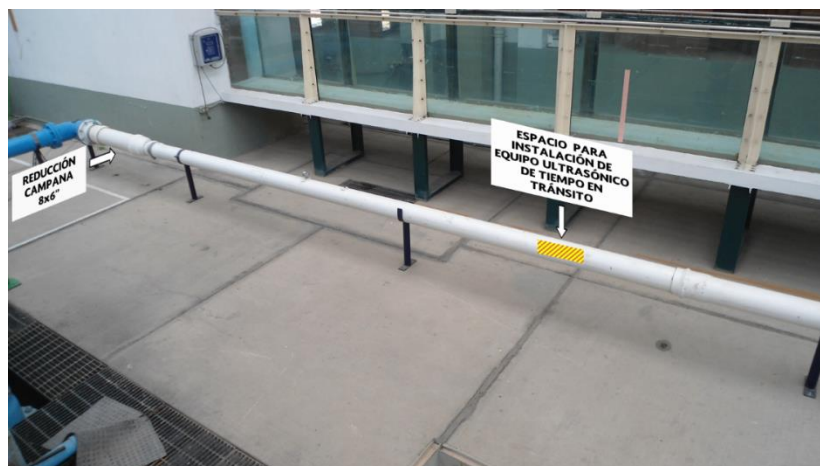
Ilustración 2.9. Ubicación de reducción campana y espacio para la instalación de equipo ultrasónico de tiempo en tránsito.
