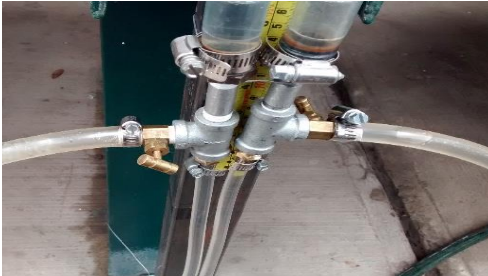
Ilustración 2.20. Vista de la derivación para purga de aire, ubicada en la parte baja de los tubos piezométricos.
