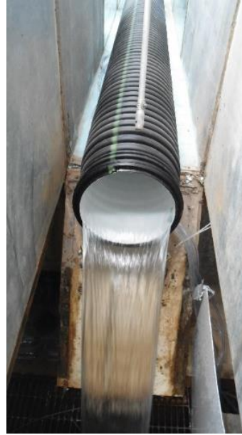
Ilustración 3.26. Vista de la descarga de la tubería de prueba al canal de recirculación.
