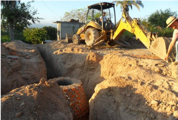
Foto 1. La construcción de drenajes subterráneos es una actividad muy compleja que necesita de planeación y maquinaria.
