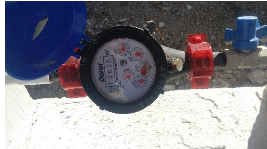
Ilustración 7. Válvula antifraude instalada en otro medidor de 1/2".
