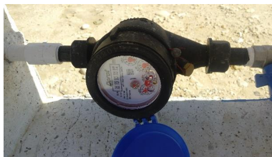
Ilustración 2. Otro medidor de 1/2" instalado
