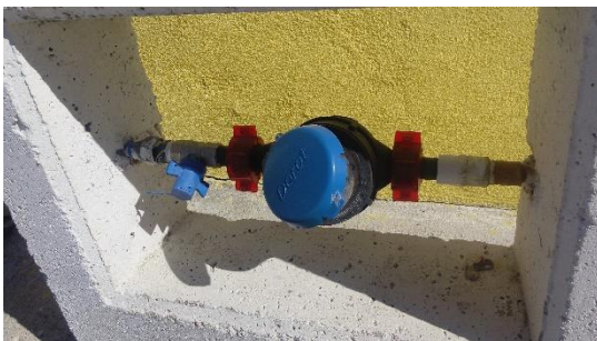
Ilustración 8. Materiales y piezas especiales para la adecuación del cuadro del medidor.
