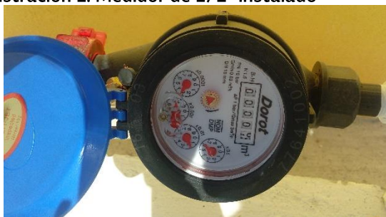
Ilustración 3. Medidor de 1/2" instalado en el municipio de Acuña
