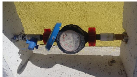
Ilustración 9. Materiales y piezas especiales para adecuación del cuadro de medidor.
