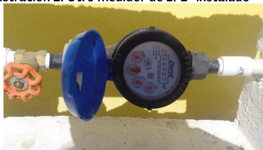
Ilustración 4. Medidor de media pulgada instalado
