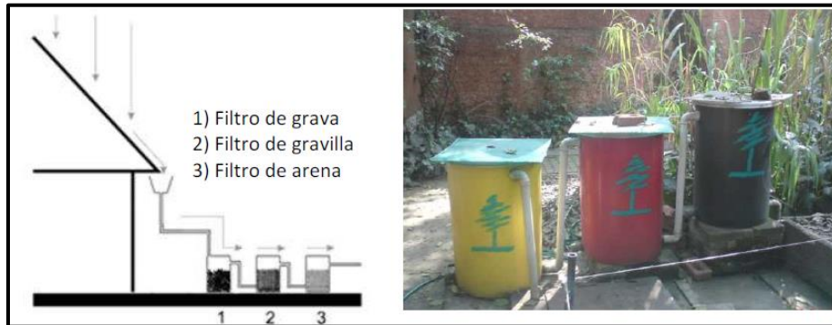
Figura 1.3 Sistema de captación de lluvia de la casa ecológica del parque Loreto y Peña Pobre, Ciudad de México
