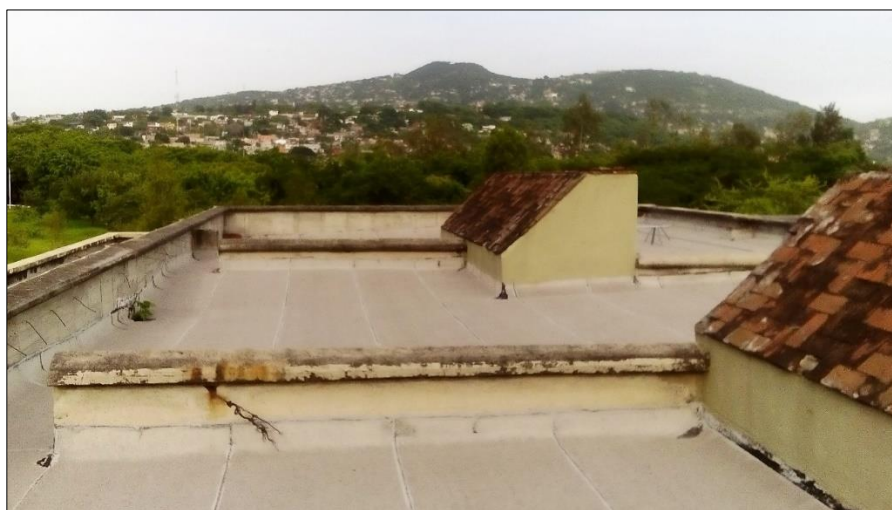
Figura 2.4 Techo EP, para la captación de agua de lluvia
