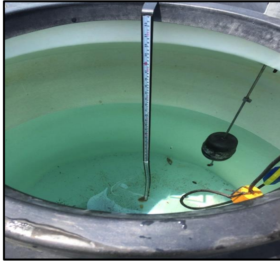
Figura 2.3 Tinaco N°1 de almacenamiento de agua para ser distribuida al EP
