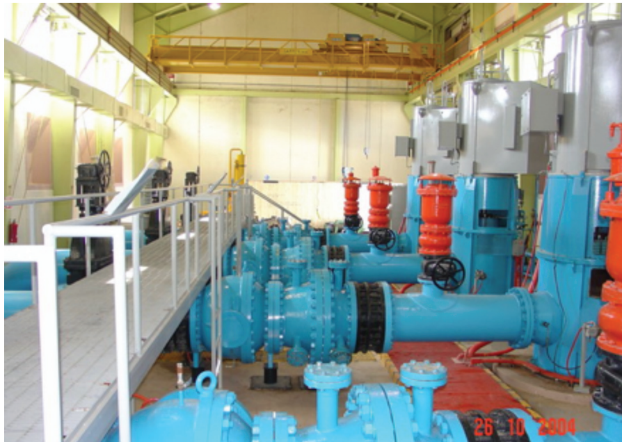
Figura 5.1.6 Instalación normal de la válvula expulsora de aire a la descarga de las bombas.
