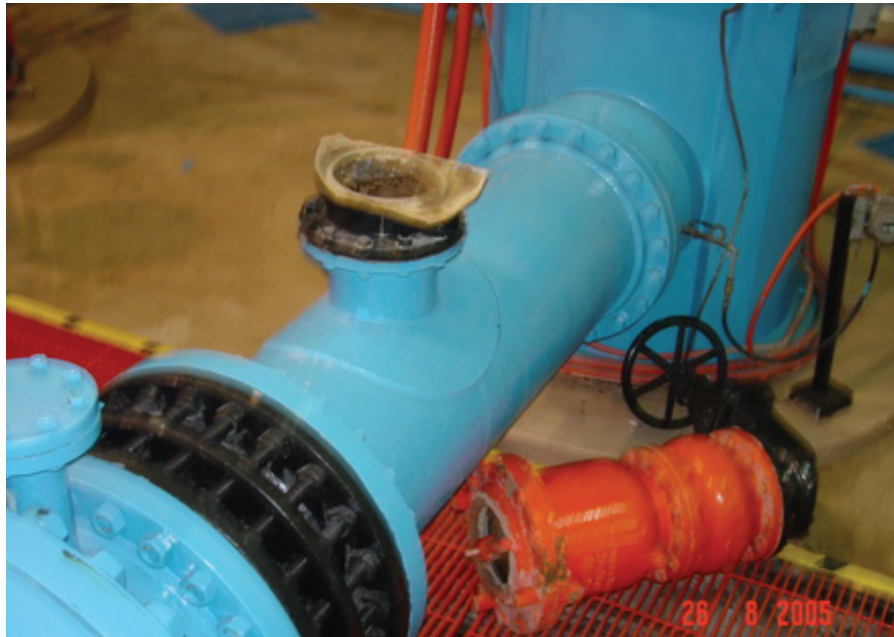
Figura 5.1.5 Accidente de fractura de una válvula de compuerta de 10" clase 125
