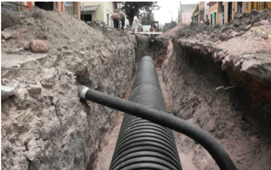
Figura 6.1.55 Sistema temporal del agua instalado
