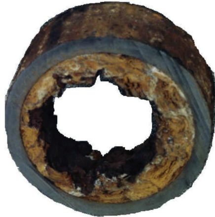
Figura 6.1.61 Tubería con incrustaciones con origen de corrosión por tuberculación.
