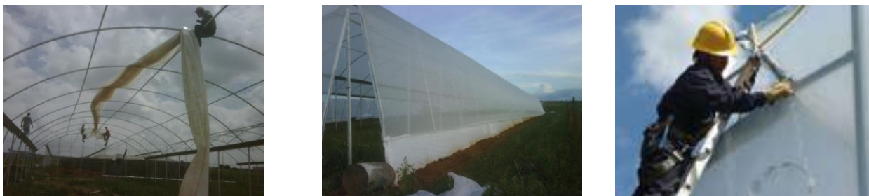
Instalación de malla anti afidos en laterales hule plástico sobre el techo
