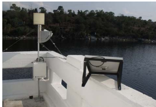
Fotografía 1. Sistema de medición con distanciómetro láser inclinado, adquisición de datos, antena de radio y panel solar.
