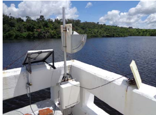
Lidar instalado en "Valsequillo" (Pue.)
