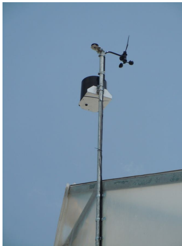
Ilustración 1.16. Sensores de radiación solar, viento y lluvia en el techo del invernadero.
