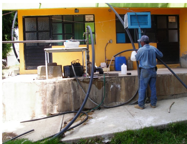
Ilustración 1.1. Tanque-cisterna de almacenamiento del agua.
