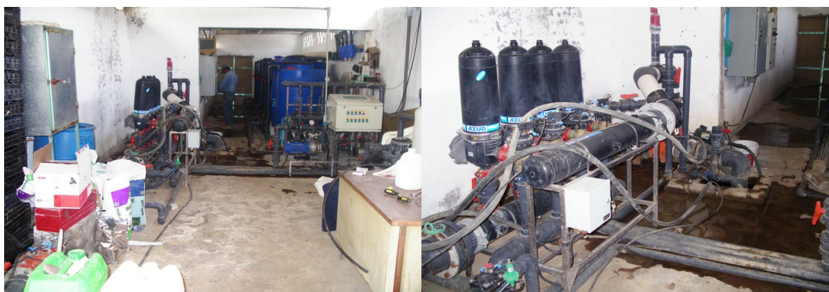
Ilustración 1.18. y 1.19. Cabezal del sistema de riego. Equipos de inyección de fertilizante y equipo de filtrado.
