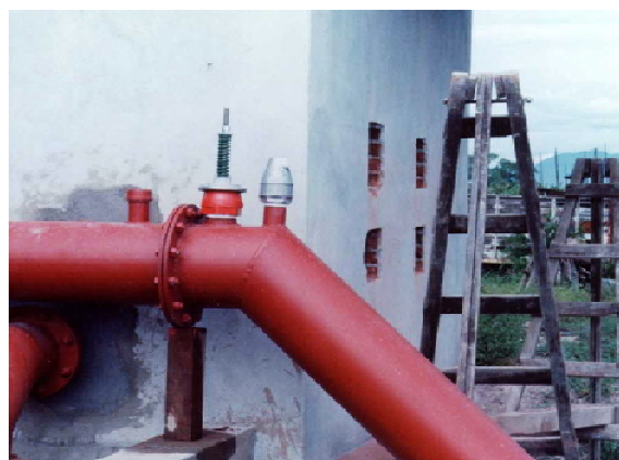
Ilustración 5.28. Integración de válvula de alivio de presión, con válvula de admisión y expulsión de aire, en las funciones de seguridad.
