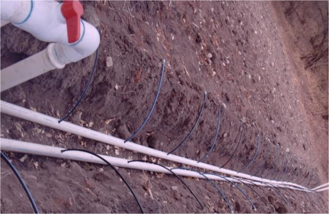
Figura III.56 Líneas regantes del sistema de riego.
