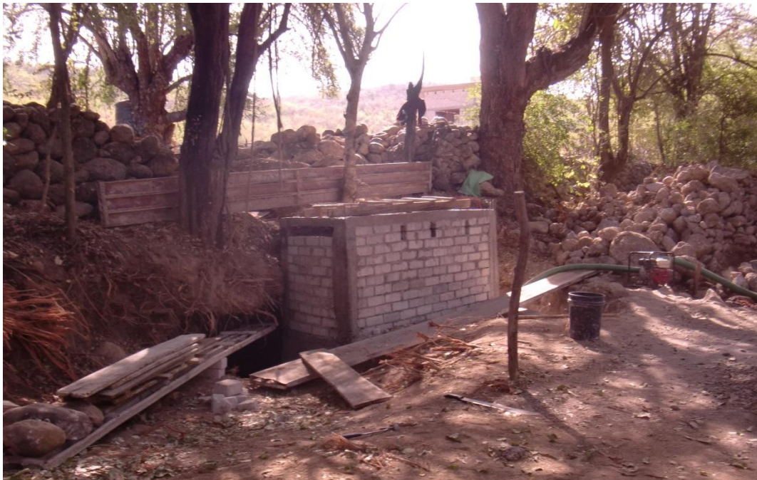
Figura III.51 Cárcamo de bombeo
