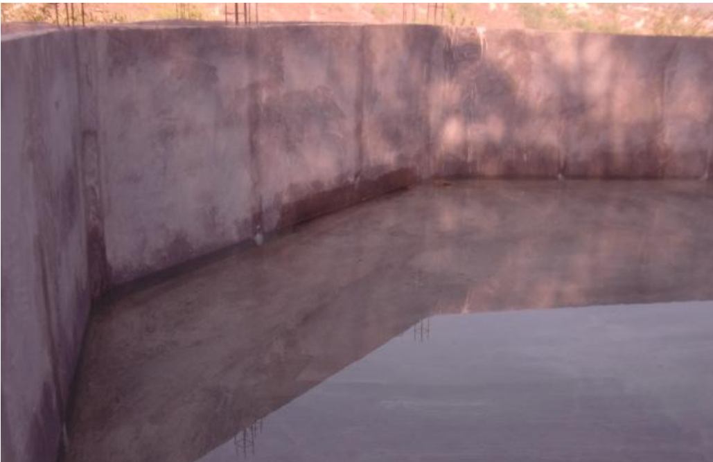
Figura III.52 Tanque de almacenamiento elevado
