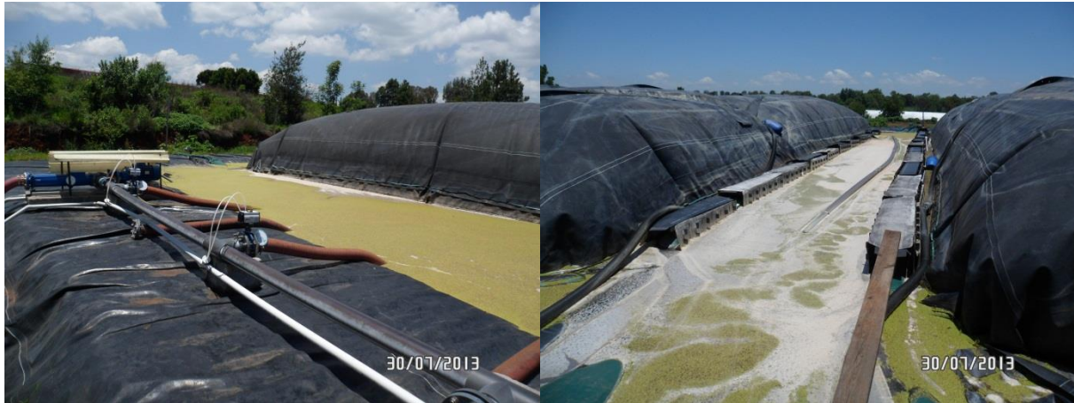
Figura 4.3. Digestores anaerobios para el tratamiento de vinazas de la tequilera Centinela
