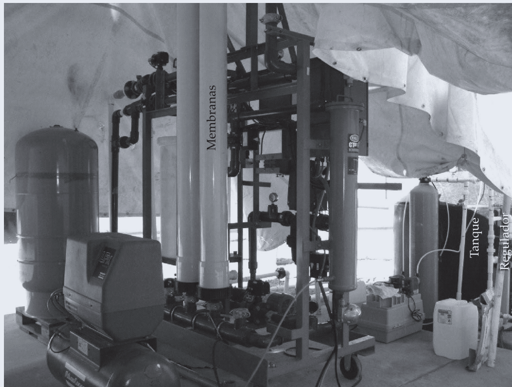
Figura 1. Instalación del piloto de microfiltración asistida por coagulación.
