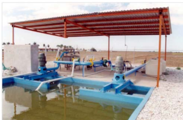
Figura 4.15. Cárcamo rectangular y planta de bombeo con bombas de turbina vertical.
