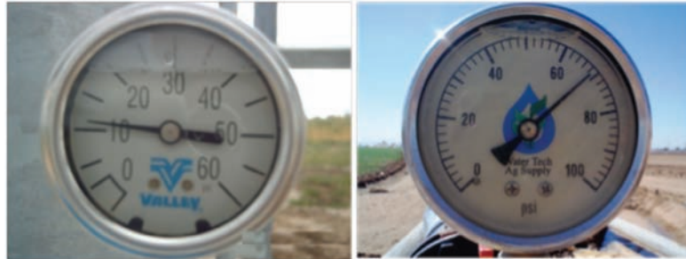
Figura 4.13. Manómetros con glicerina (reductora de vibraciones).
