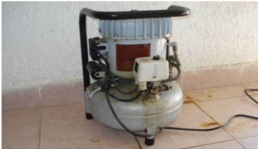
Fotografía 3.1 Equipo utilizado para suministrar la aeración
