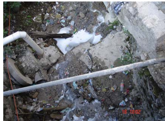
Figura 2.1.9.16.d.- Descargas de aguas residuales en afluentes directos del río Huacapa.
