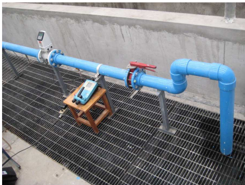
Figura C- 12. Extremo final de la tubería para mantener lleno el conducto
