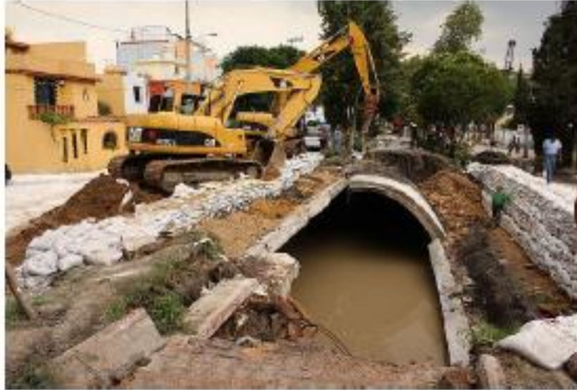
Figura 4.1. Ruptura del Túnel Emisor Poniente Ciudad de México 2009
