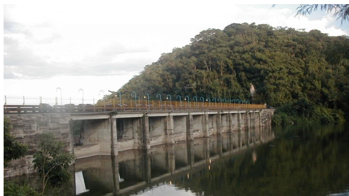
Ilustración 5.6. Vista de la parte posterior de la obra de excedencias de la Presa "Temascal".
