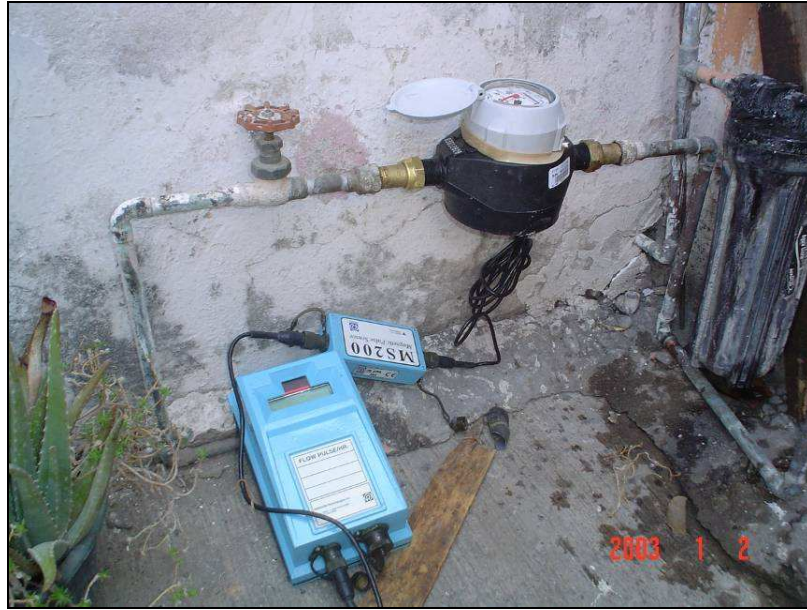
Ilustración 4.7. Instalación en campo de equipos de medición
