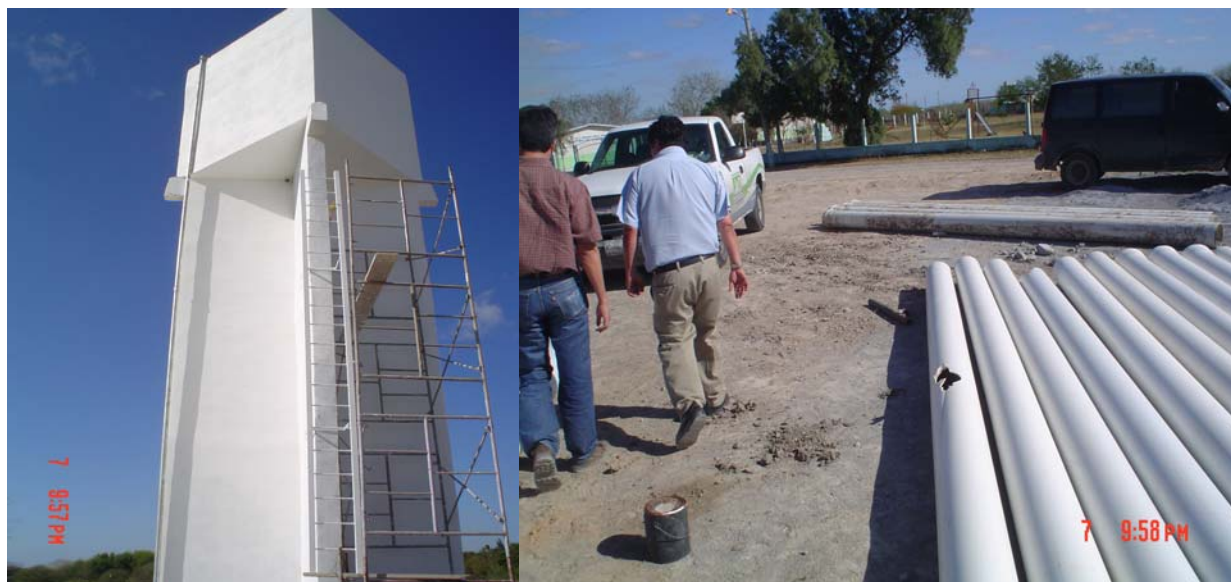
Ilustración 4.1. Tanque San Lorenzo, cadenamamiento a partir del sector Naval, 10+000.
