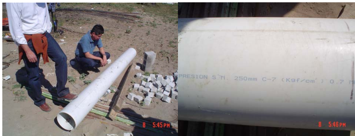
Ilustración 4.10. Tramo de tubería de diez pulgadas, clase 7, ubicación Tramo San Lorenzo – km 60+000 (aproximadamente).
