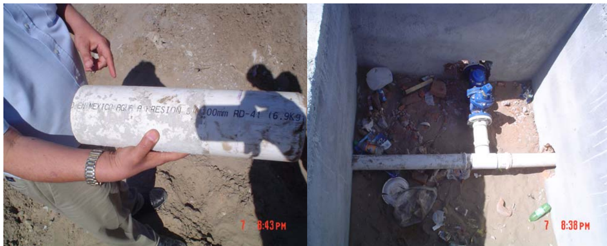
Ilustración 4.9. Tramo de tubería de cuatro pulgadas, RD-41, ubicación poblado Las Higuerrillas.
