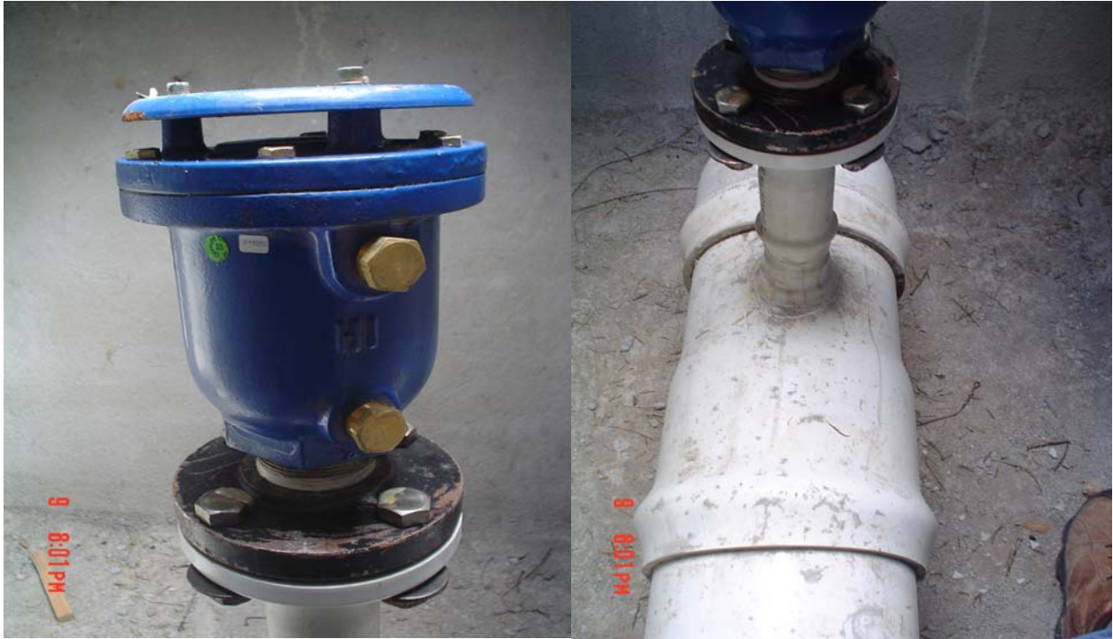
Ilustración 4.12. Válvulas de admisión y expulsión de aire instaladas sobre la conducción hacia el puerto El Mezquital.
