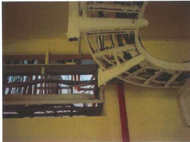
Figura 54. Cableado interno de la Central Hidroeléctrica.
