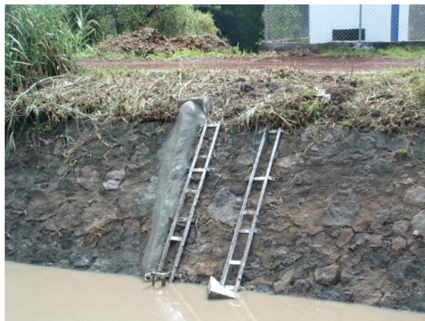
Cubierta de cable en Punto de control San Nicolás
