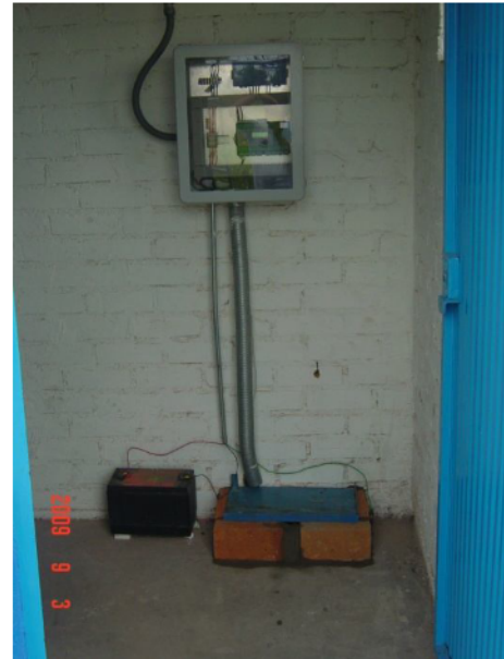
Cambio de Celda solar, y gabinete en Branif
