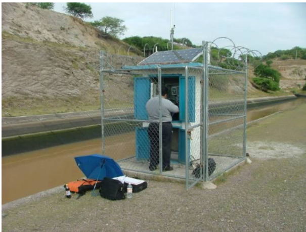
"Chilatán (Toma Alta)" Revisión del medidor
