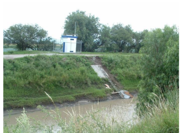
Primer padrón. Caseta pintada, protección de cable de sensor, y base de sensor.
