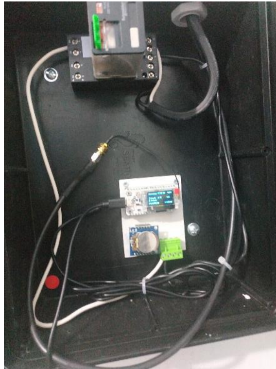
Figura 3.74. Equipo en funcionamiento
