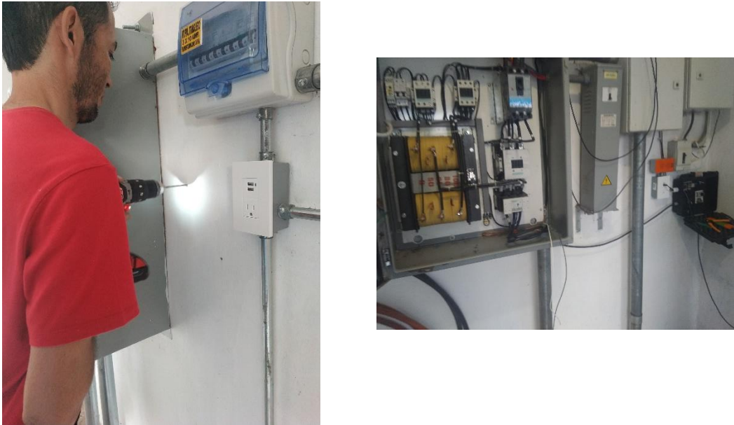
Figura 3.33 Localización del gabinete con equipo LoRa (izquierda) y conexión al arrancador (derecha)
