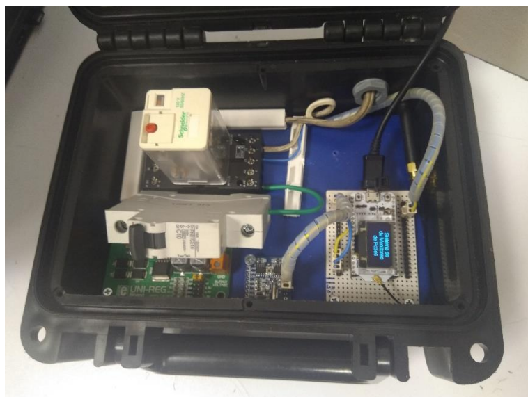
Figura 3.78. Equipo en funcionamiento
