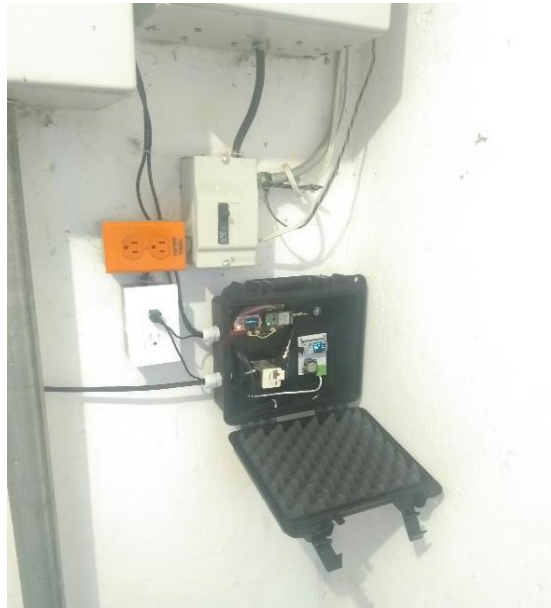
Figura 3.59 Equipo en funcionamiento
