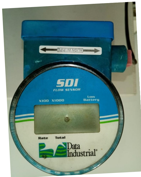
Figura 3.64. Display digital medidor SDI pozo no. 22
