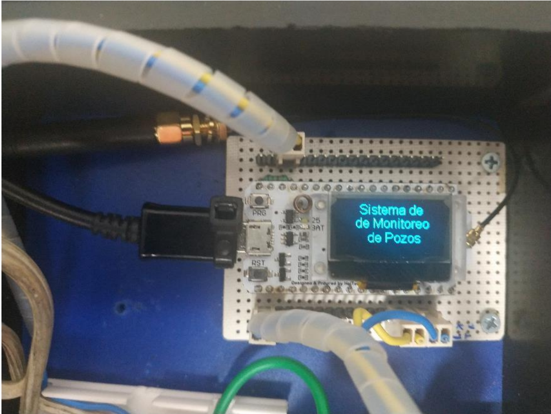
Figura 3.43 Equipo en funcionamiento
