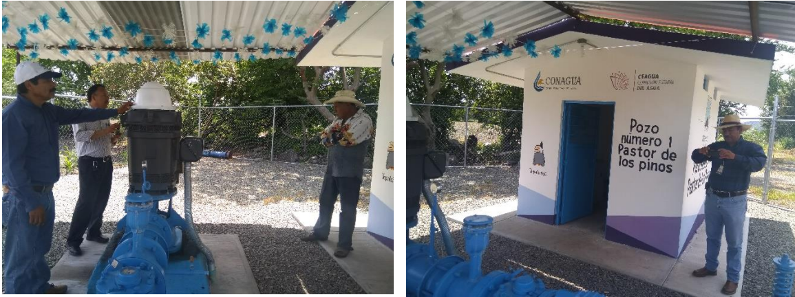
Figura 3.27 Pozo #1 “Pastor de los Pinos”.
