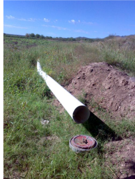
109+500, el primer hidrante está muy cerca
