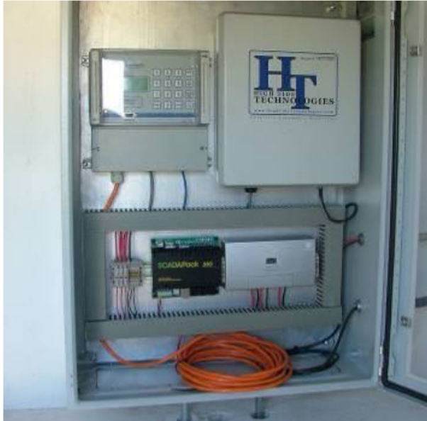
"CP km 95+330" (Tepanco de López) Medidor y telemetría satelital
