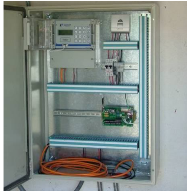
Gabinete del aforador tipo AGL
