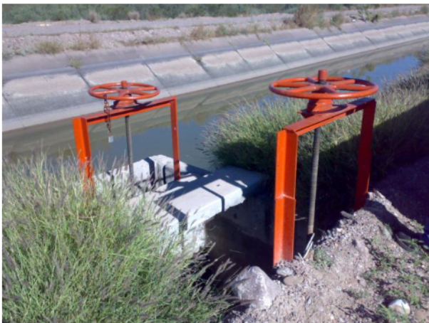
Sitio 108+510 Caja primaria, aforador tipo "Tecamachalco"
