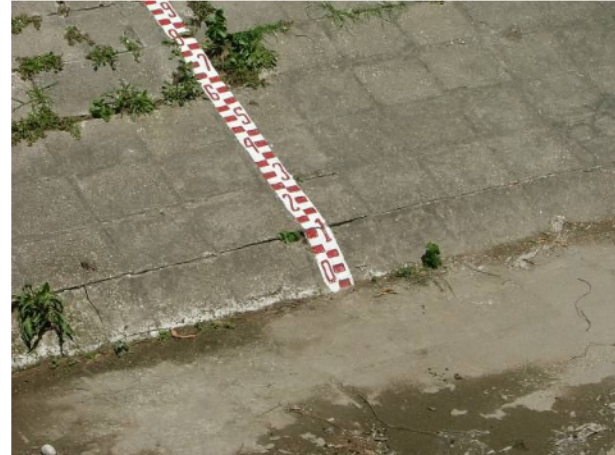
"Canal lateral km 51+180" Talud deformado
