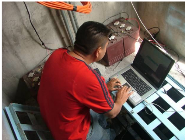
"Valsequillo" km 24+769 Verificación del sensor de nivel
