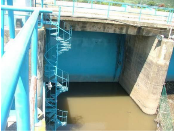
Compuerta de emergencia
