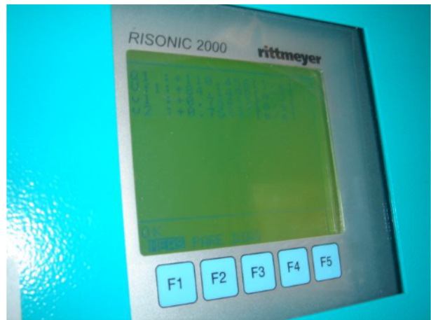
Aforador de tiempo de travesía del DR034 Estado de Zacatecas. Detalle de pantalla de medición.
