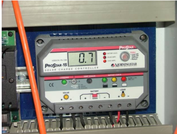
"Valsequillo" km 24+769 Verificación del controlador de carga
