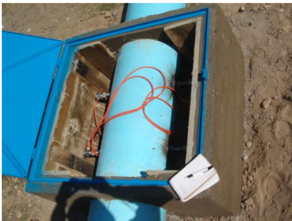
Aforador de tiempo de travesía del DR034 Estado de Zacatecas. Detalle de sensores.
