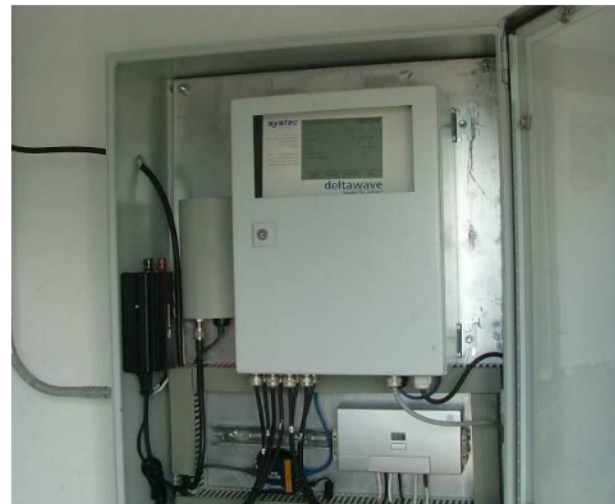
"CP km 53+100" (Tecamachalco) Medidor
