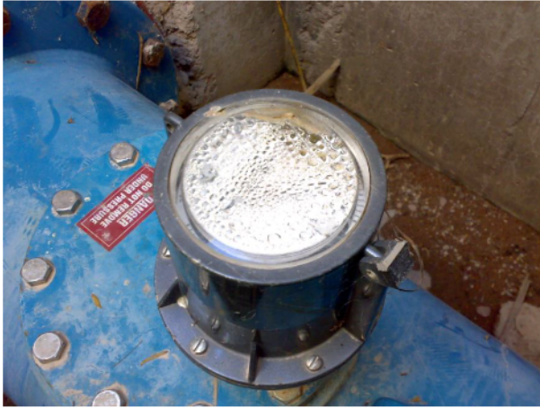
120+020, Medidor de propela marca Mc Crometer, carátula empañada
