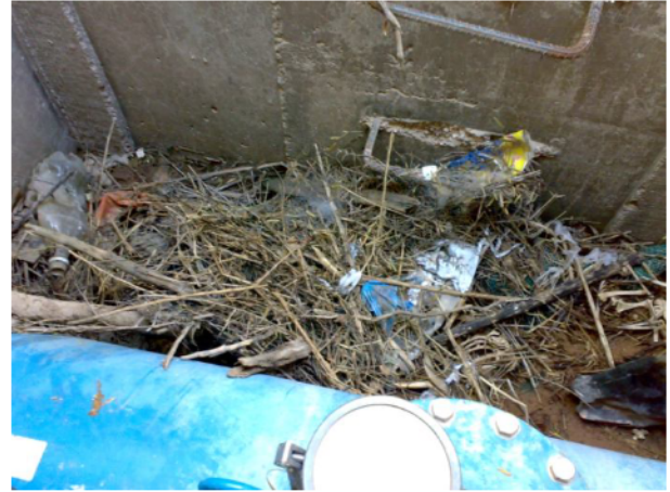
120+020, Al parecer el medidor estuvo bajo el agua, los restos de hierba y madera así lo indican.
