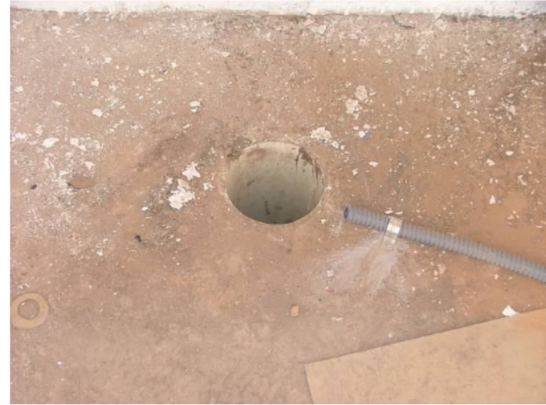
(d) Orificio dentro de la caseta, para colocar el sensor de nivel
