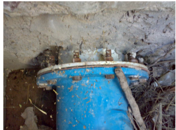
120+020, Unión del medidor con la tubería que parece ser de PVC.
