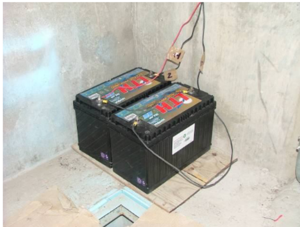
"Valsequillo" km 24+769 Nuevas baterías
