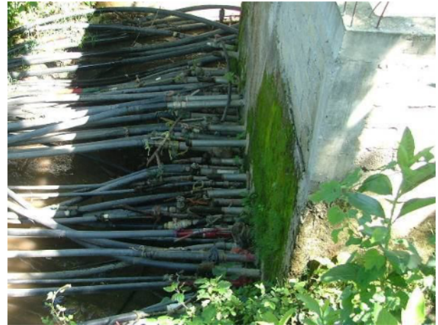
Mangueras que salen del tanque (cerca de "Timbineo")
