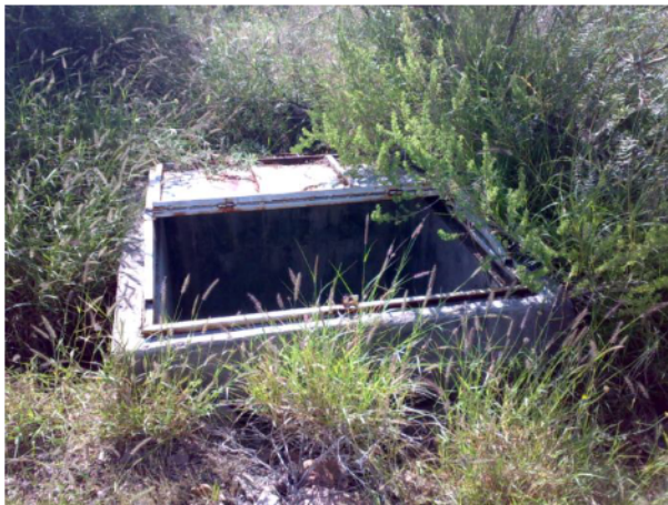
120+020, Vista exterior de la caja de alojamiento
