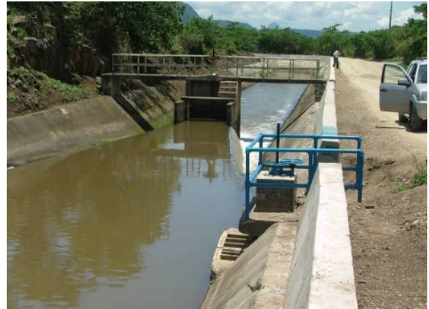
Pico de pato y toma con módulo "Aqua Control" ("La Chalupa")
