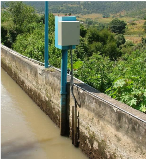
ADL reinstalado, después de haber cambiado su cable
