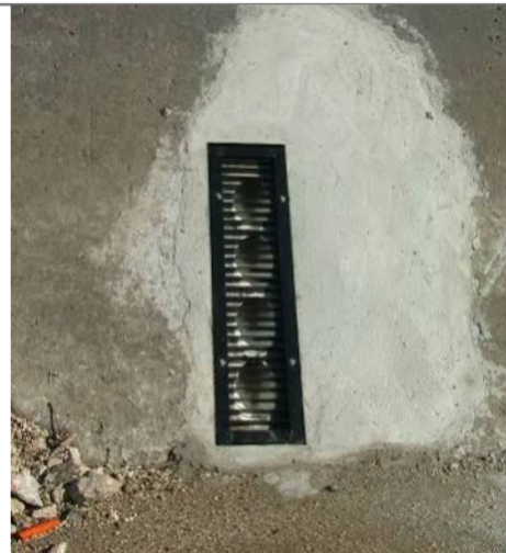
"CP km 95+330" (Tepanco de López) Conexión al pozo de observación
