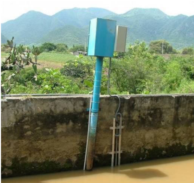
Primer aforador tipo ADL instalado en el canal (se ven sus rieles)
