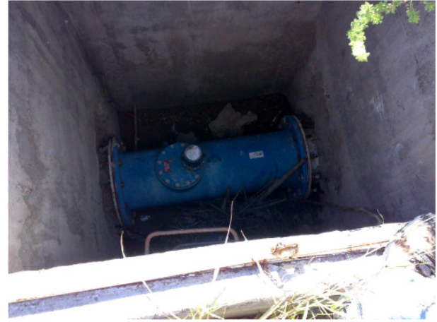
120+020, Vista interior de la caja de alojamiento del medidor
