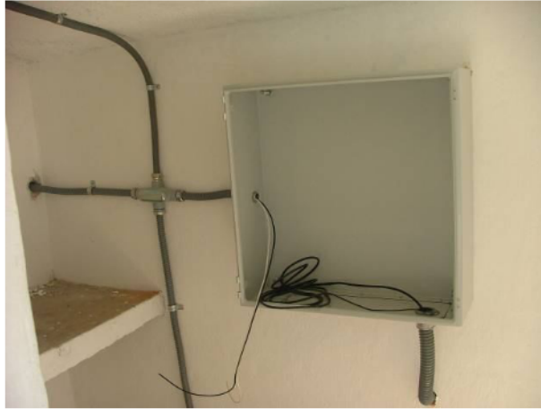
(c) Gabinete para alojar el sistema de medición
