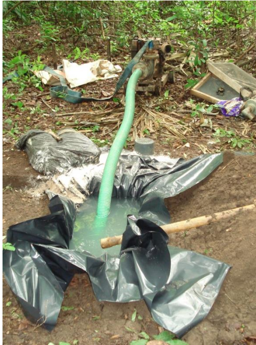
Figura 124 Fosa de fluidos de perforación
