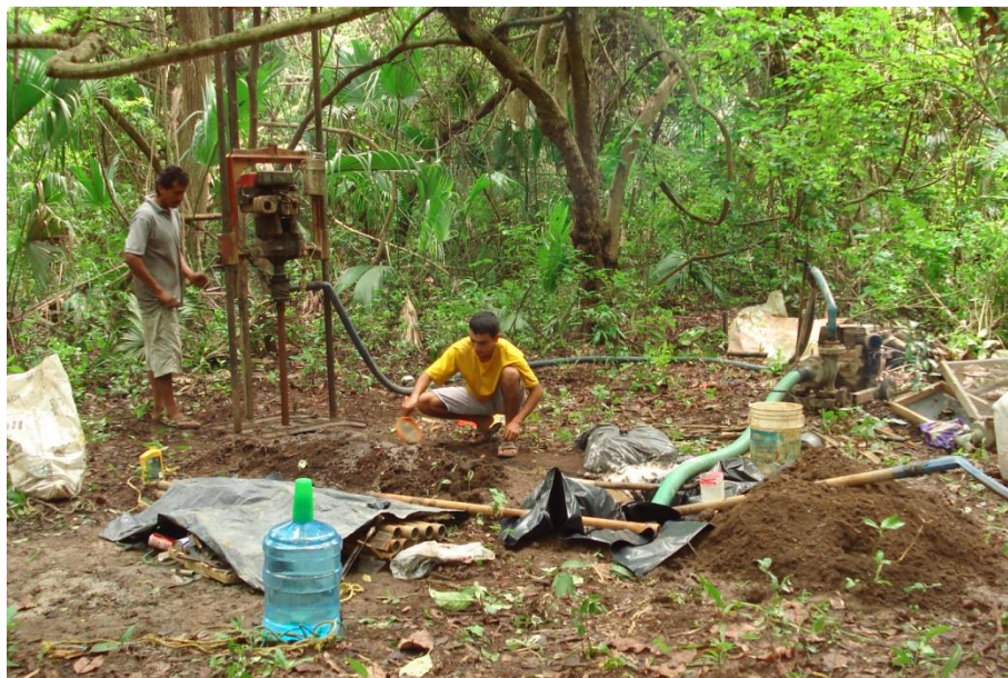
Figura 125 Sistema de bombeo de fluidos de la fosa a la tubería de perforación
