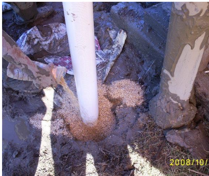
Figura 116 Colocación del filtro
