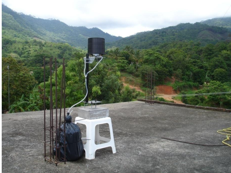
Figura 104 Piezómetro instalado en San José de las Flores
