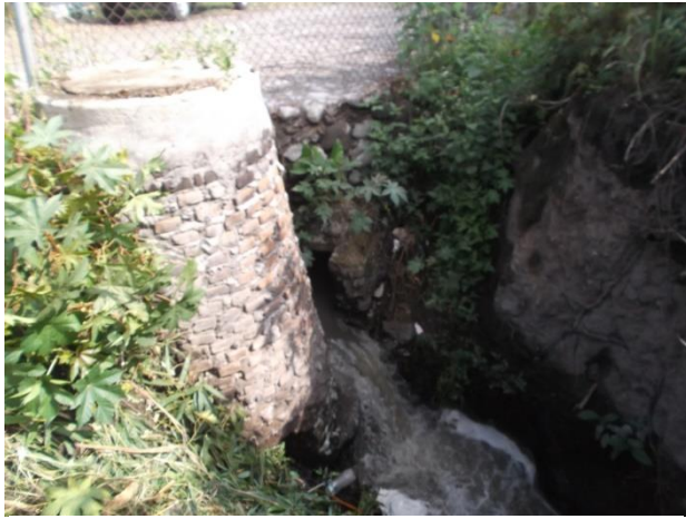
Figura 14. Colector de aguas residuales roto.
