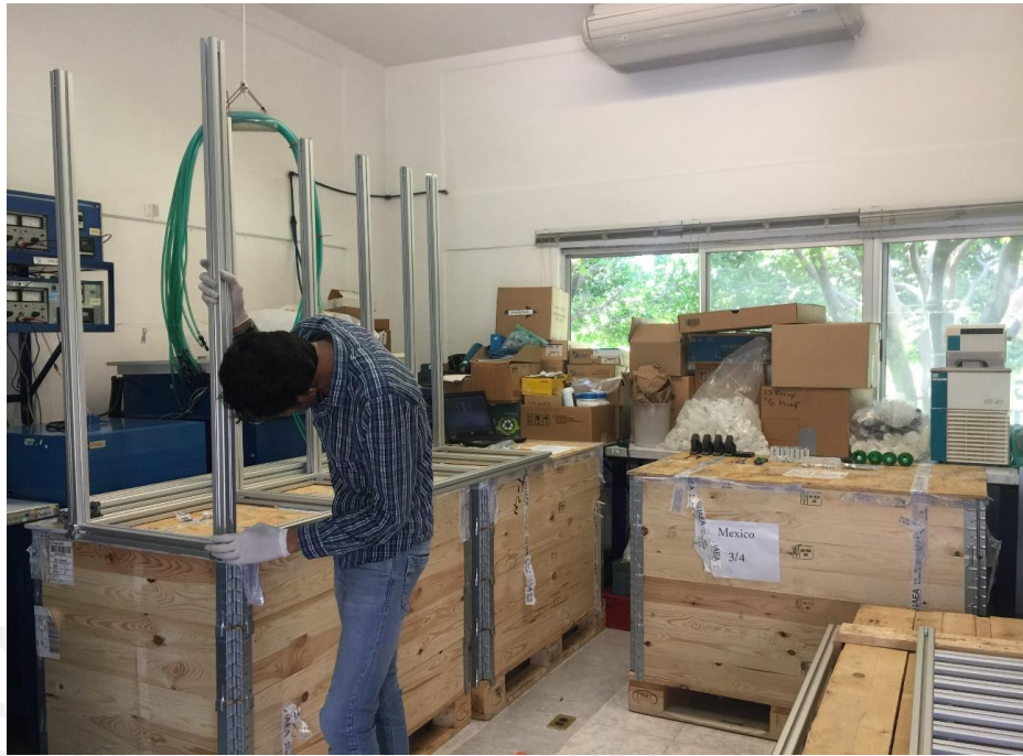
Figura 33 Personal de la empresa ensamblando la cara central del soporte estructural RACK
