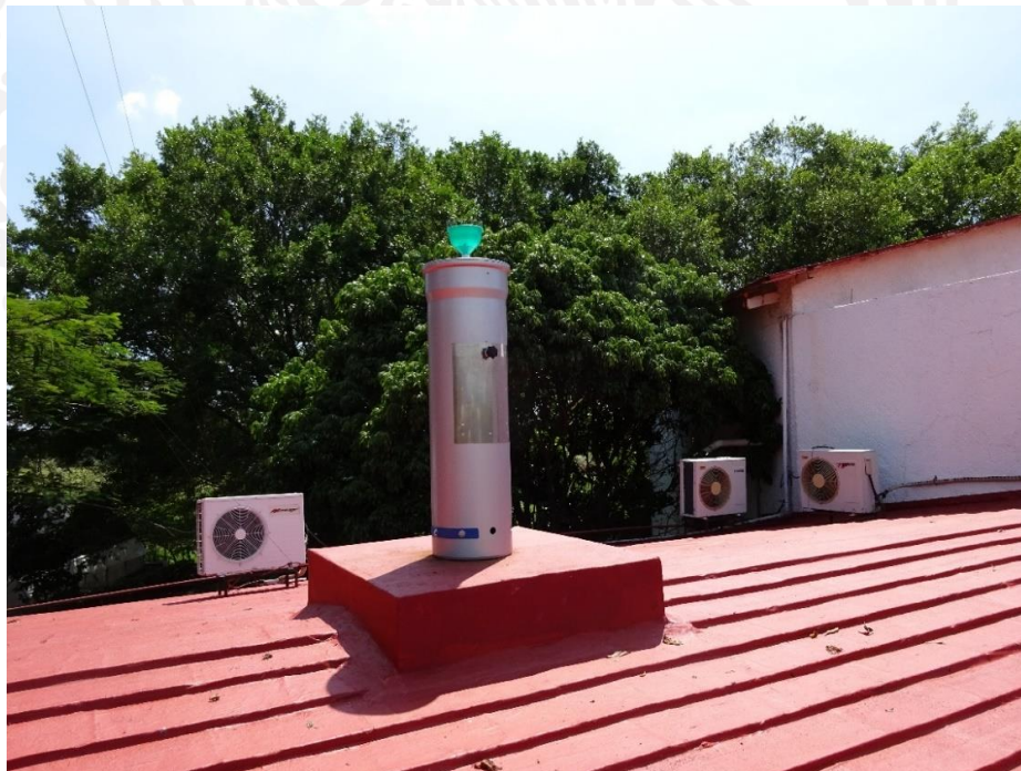
Figura 147 Colector instalado en FIRA Tezoyuca, Morelos
