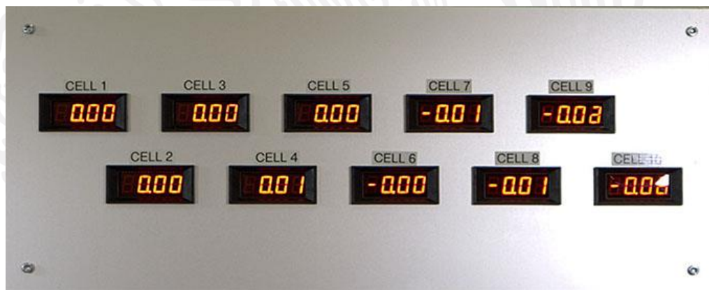
Figura 11 Voltímetros digitales tipo LED, se utilizan para registrar y monitorear la caída de voltaje a través de cada celda electrolítica.
