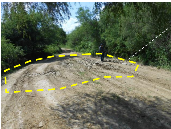
Fotografía II.18 Zona deformada y con baches del camino de terracería al pie del talud.
