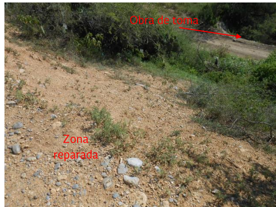
Fotografía II.31 Detalle del material en la zona reparada.
