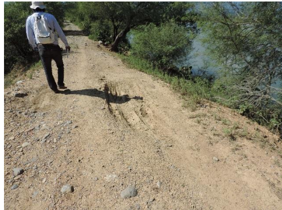
Fotografía II.11 Baches sobre la corona.
