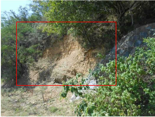
Fotografía VII.4 Aspecto de la zona erosionada de la ladera derecha.
