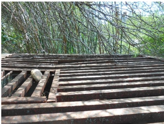
Fotografía VII.12 Rejilla metálica de protección de la caja de válvulas de la obra de toma.
