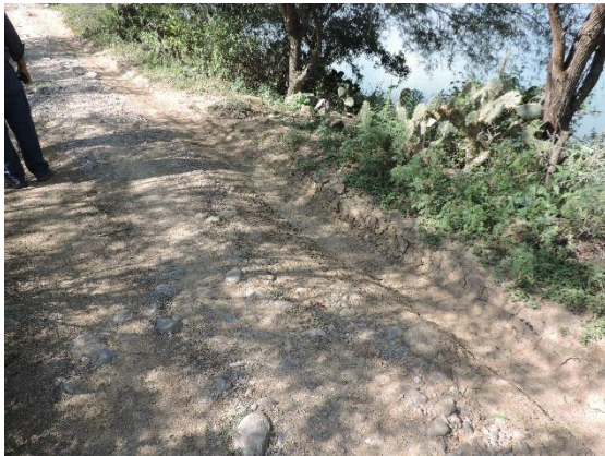
Fotografía II.10 Deformaciones de la corona por el paso de vehículos automotores.
