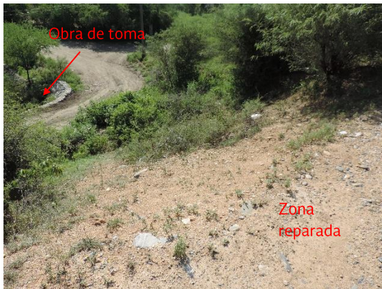
Fotografía II.30 Detalle del material en la zona reparada.
