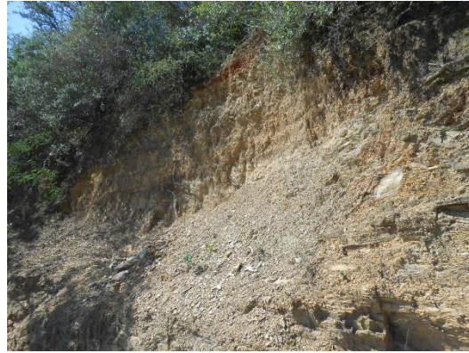
Fotografía VII.5 Detalle de la zona erosionada de la ladera.
