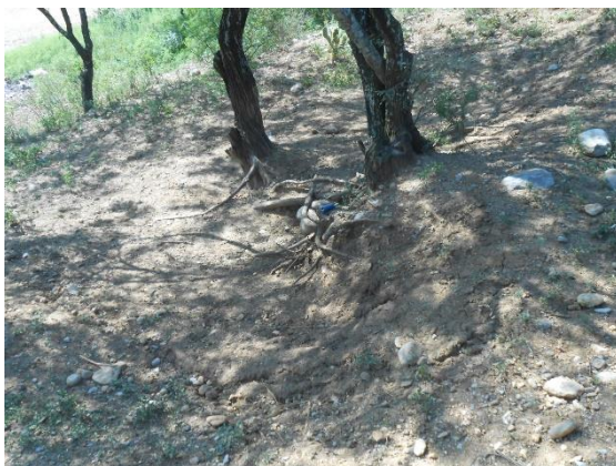
Fotografía II.22 Material del talud aguas abajo expuesto y erosionado.
