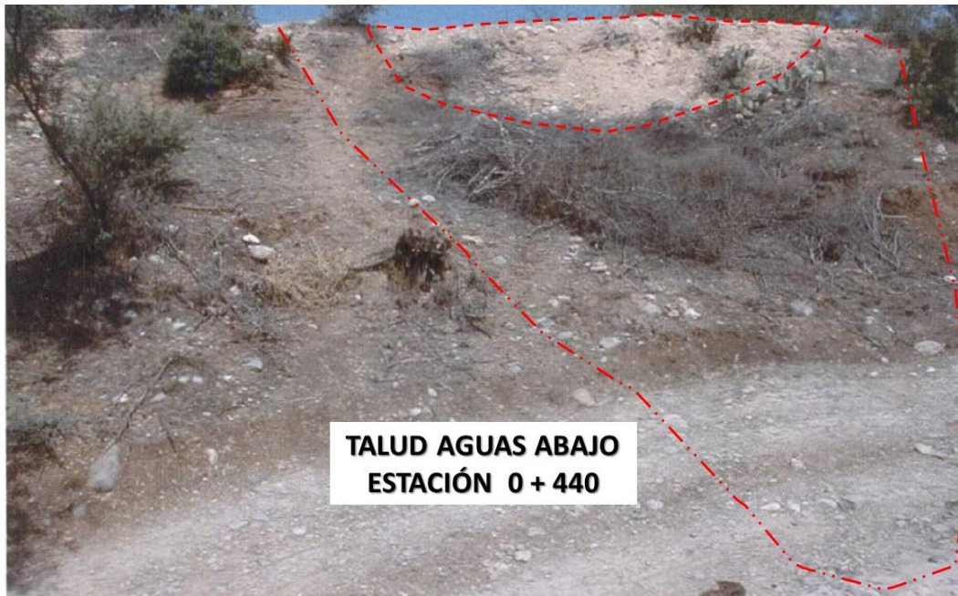
Fotografía VI-4. Zona del deslizamiento o erosión causado con embalse encima del NAMO y lluvias del huracán Alex en 2010 ya rellenado en 2011.
