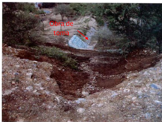
Fotografía II.26 Aspecto de la erosión del talud aguas abajo ocurrida en julio de 2010.
