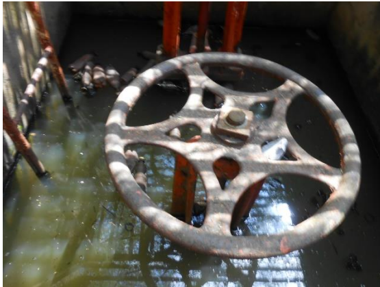
Fotografía II.44 Válvula tipo compuerta, de emergencia.
