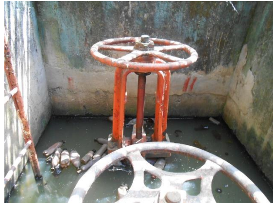
Fotografía II.45 Válvulas tipo compuerta, de servicio.
