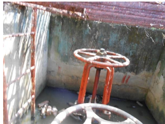
Fotografía VII.13 Escalera para el acceso a la caja de válvulas.
