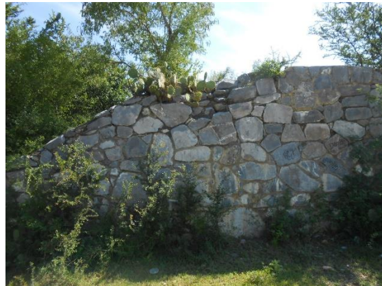
Fotografía II.39 Zona de la mampostería deteriorada en la parte superior.
