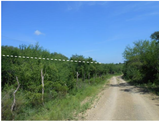
Fotografía II.16 Aspecto del talud aguas abajo, en el extremo izquierda de la cortina.
