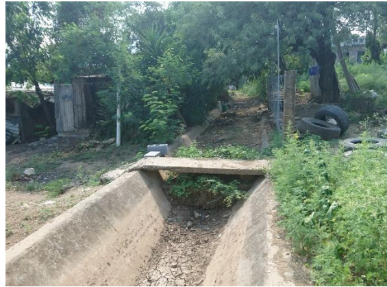
Fotografía II.47 Canal obstruido e invadido por lugareños.
