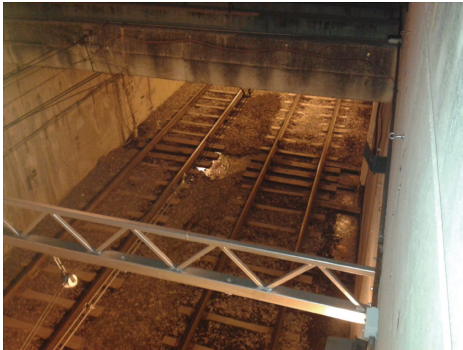
Fotografía 1. Unión túnel rampa. Surgimiento de agua freática a través de la junta de la unión.
