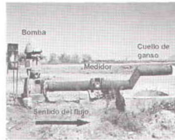
Figura 5.1 Si la instalación descarga a la atmósfera es necesario colocar un cuello de ganso en la descarga.
