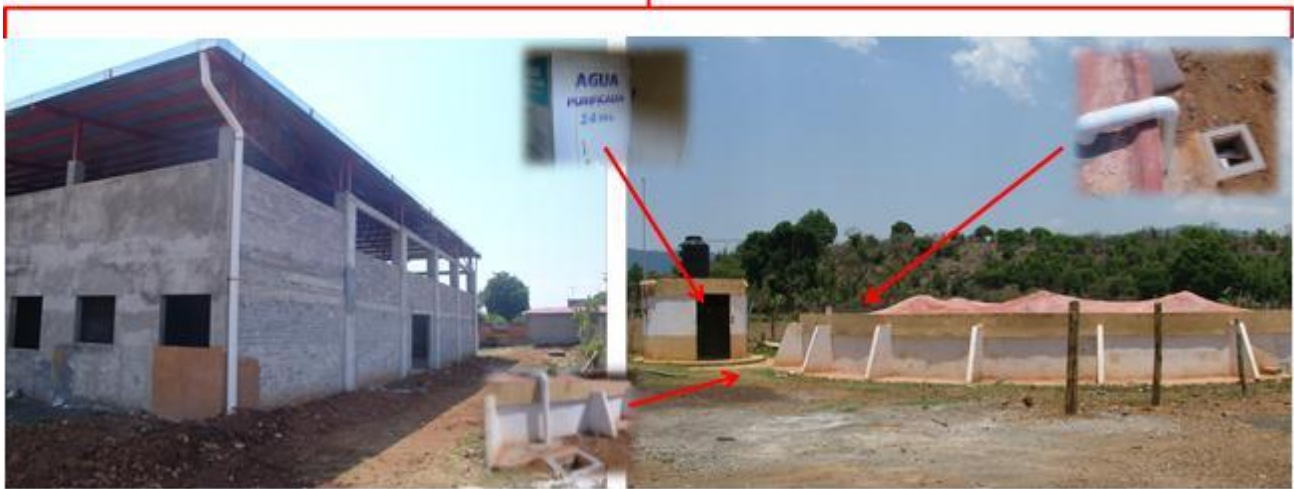
Ilustración 29. Sistema de tratamiento de agua de lluvia (San Francisco Úricho)
