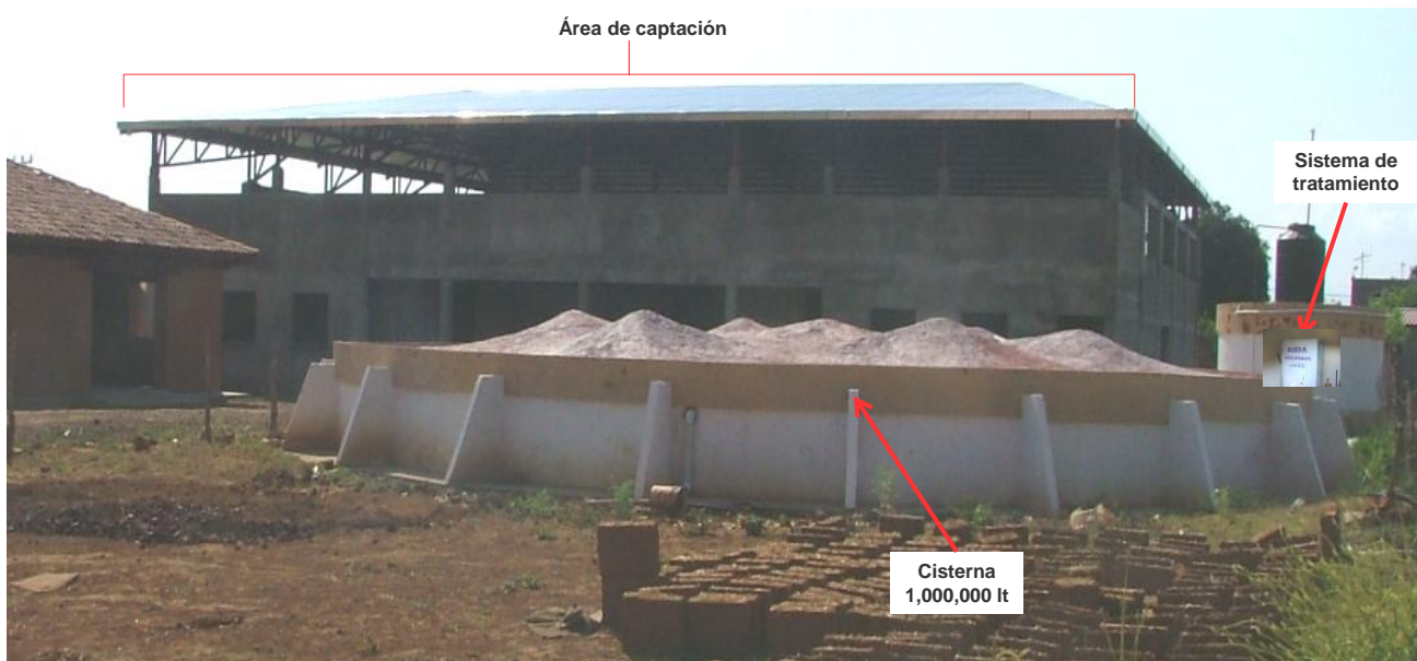
Ilustración 28. Sistema de captación y conducción de agua de lluvia (San Francisco Úricho)
