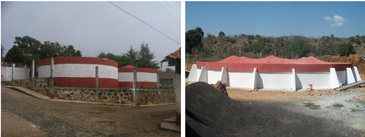
Ilustración 2. Sistemas de almacenamiento – cisternas de 100 y 1,000m 3 .
