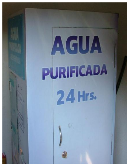
Ilustración 4. Sistema de tratamiento de agua en la comunidad de San Francisco Uricho
