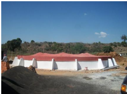
Cisterna techada y pintada
