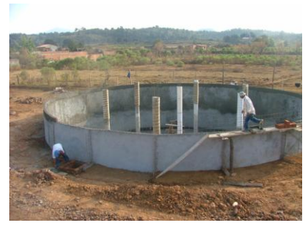
Vista cisterna 1,000,000 litros sin tapar
