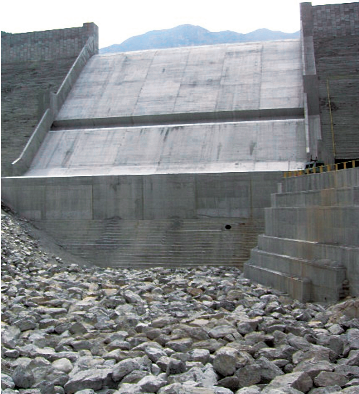
Figura 76. Aereador de la presa Corral de Palmas en el Estado de Nuevo León.
