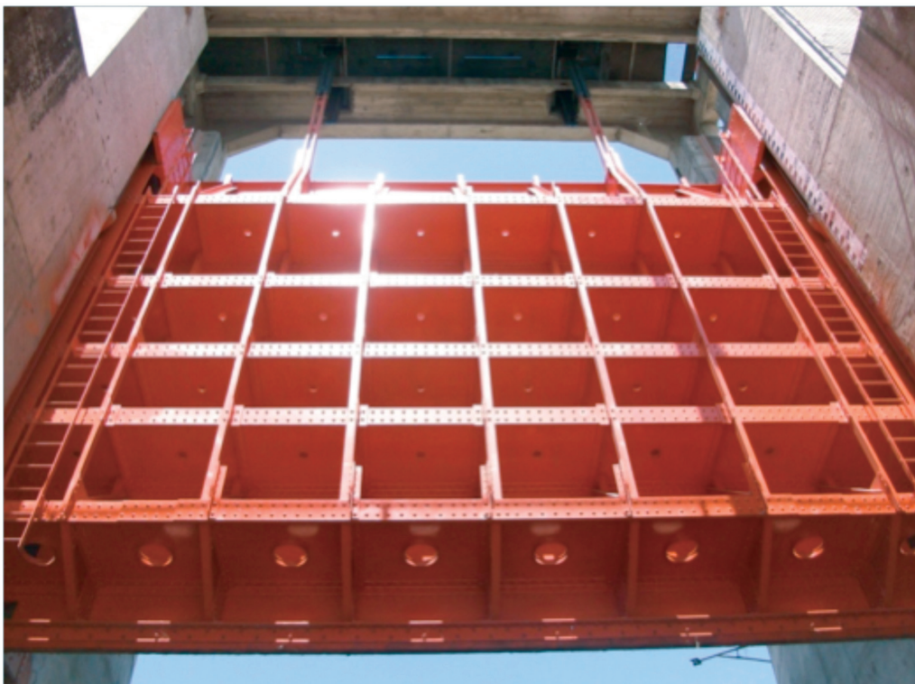
Figura 7. Compuerta deslizante, sobre el vertedor de la presa Abelardo L. Rodríguez, Tijuana, Baja California.
